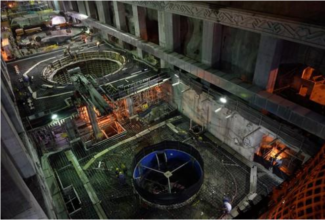
Figura 9. Inundación casa de máquinas
