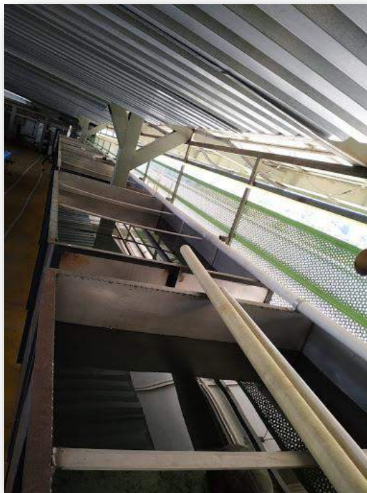
Imagen 10. Tanques de distribución de agua para sanitarios
