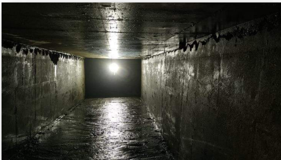
Imagen 11. Tanque de almacenamiento de agua lluvia
