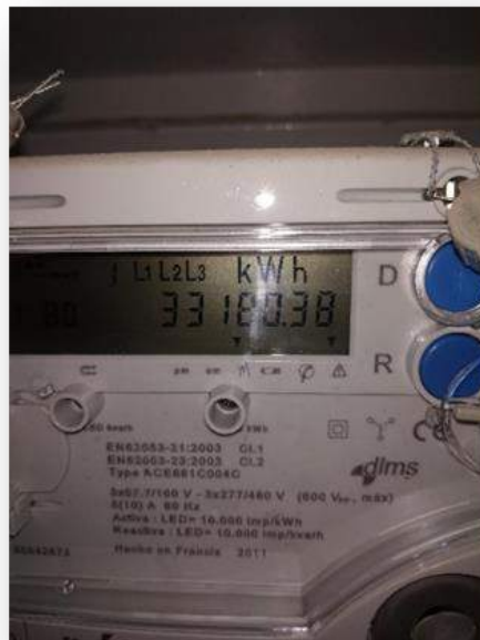
Imagen 8. Contador de energía principal del hotel.
