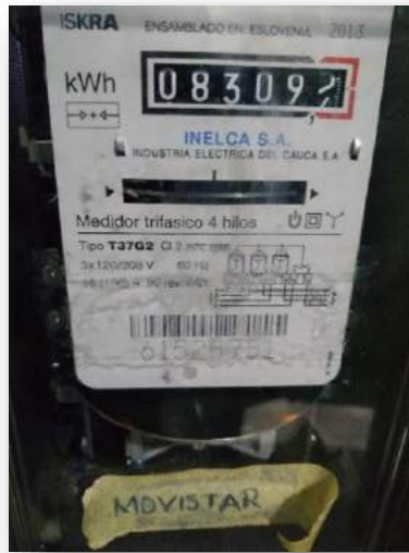
Imagen 7. Contador de energía interna Hotel.
