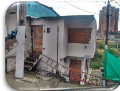
Lotes abandonados por riesgo.
