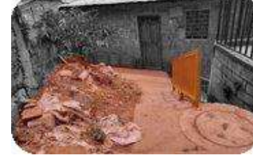
Senderos en mal estado.
