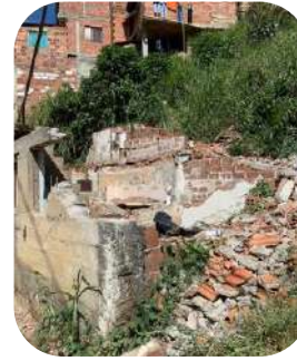
Desplome de construcciones por desbordamiento de quebrada.
