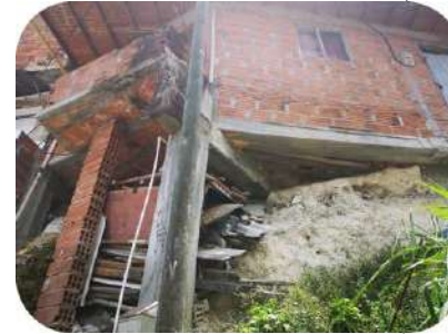
Estructura en riesgo.
