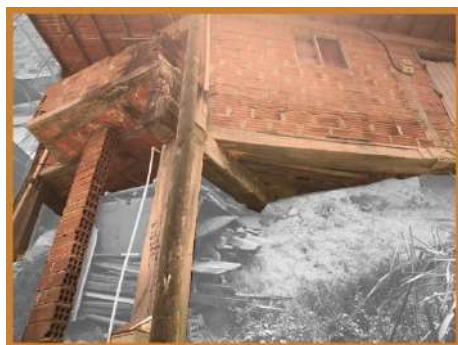
Fotografía 29. Problemática viviendas - Elaboración propia.
