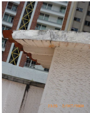
Fig. 69 Fisuras en planta segundo piso
