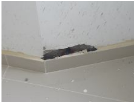
Fig. 7. Muro incompleto enchapado
