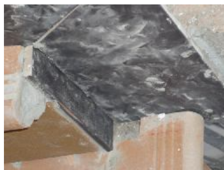
Fig. 9. Escalera mal terminada
