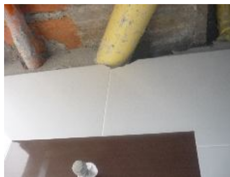
Fig. 23 Desagüe con nivel bajo
