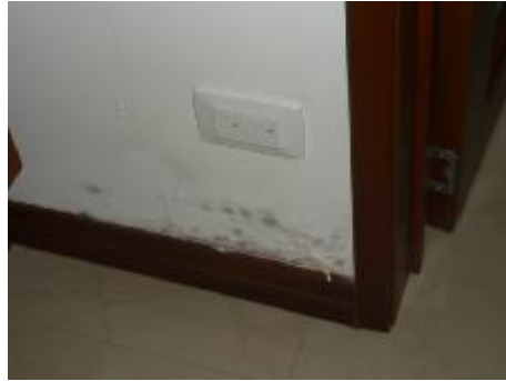
Fig. 55 Humedad en apto 301
