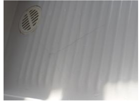
Fig. 56 Lavadero agrietado apto 501
