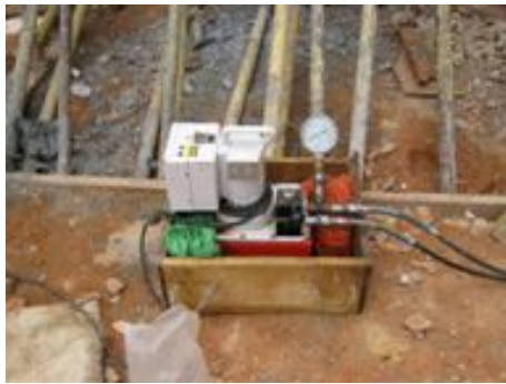
Fig. 126 Maquina hidráulica con manómetro
