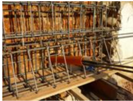
Fig. 117 Tubería evitando recubrimiento de anclajes
