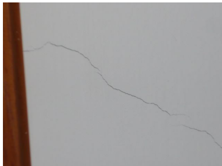
Fig. 60 Fisura muro apto 402
