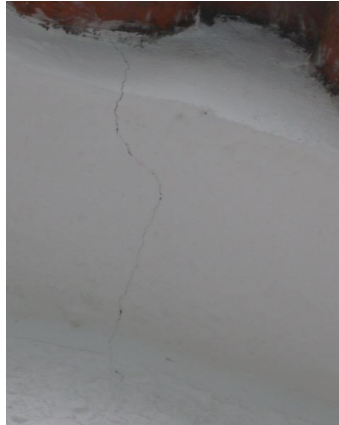
Fig.77 Fisura en soporte de cubierta
