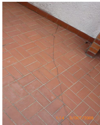
Fig. 64 Fisura de pisos en patio
