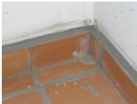
Fig. 5. Guarda escoba con defecto
