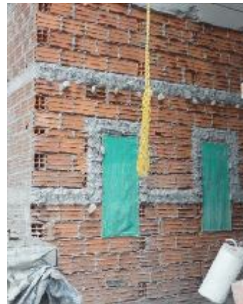
Fig. 46 Descacilada fachada lateral Apto 03 Torre A
