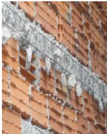
Fig. 45 Descacilada de fachada interior Apto 01 Torre B
