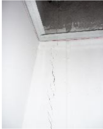
Fig. 44 Dilatación marcada 504 Torre B
