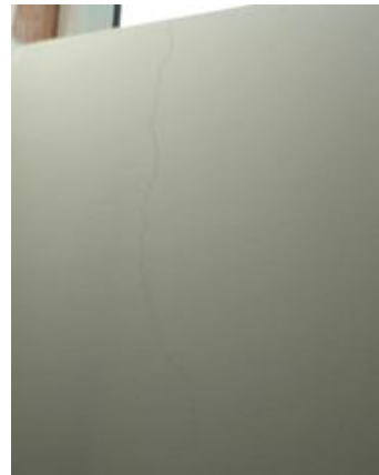
Fig. 54 Dilatación en zona de ropas
