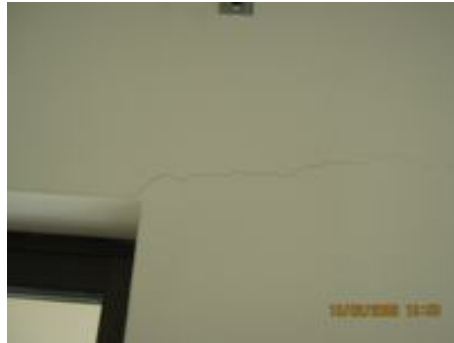
Fig. 71 Fisura en vano de ventana
