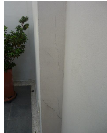
Fig. 63 Fisura Columna apto 1203
