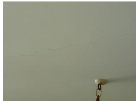
Fig. 61 Fisura techo apto 502
