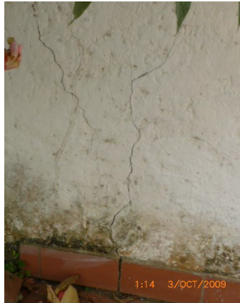
Fig. 66 Fisura muro Casa-Casa Puyana
