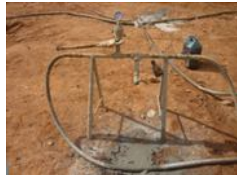
Fig. 114 Manómetro de presión de inyección
