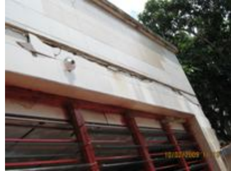
Fig. 68 Fisura en exterior de cocina
