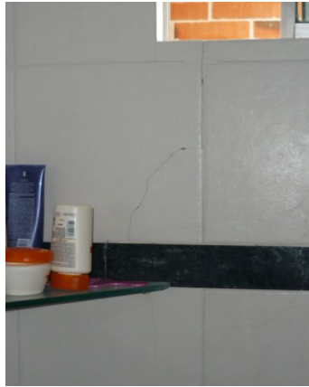
Fig. 62 Enchape de baño roto apto 301
