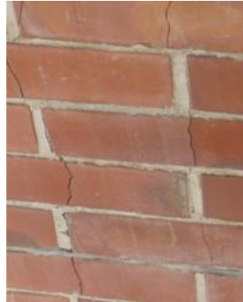
Fig. 59 Agrietamiento en mampostería
