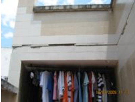
Fig. 67 Fisura en zona de ropas
