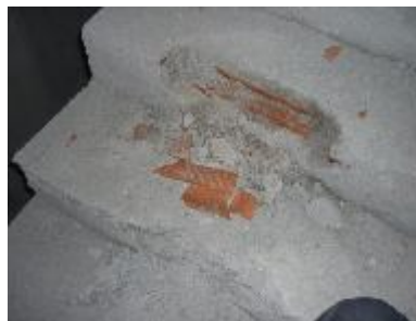
Fig. 41 Mortero de escalera defectuoso
