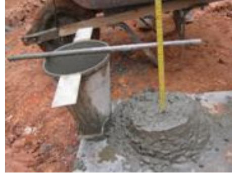
Fig. 91 Asentamiento de 8 \frac{1}{4} ". RECHAZADO
