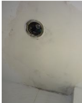
Fig. 57 Humedad Zona de ropas apto 601
