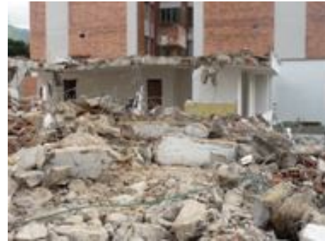
Fig. 84 Casa demolida casi en su totalidad
