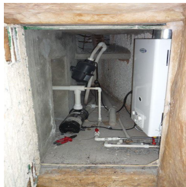
Fig. 78 Cuarto de bombas.
