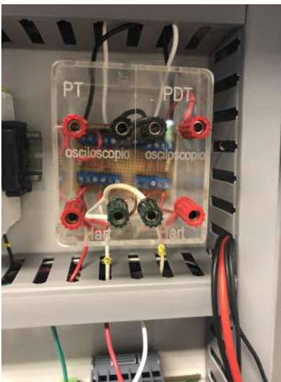
Figura 27: Arreglo de resistencias para la salida del protocolo HART para los transmisores LD301 y LD291. Fuente autor.
