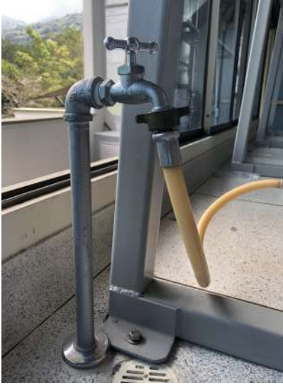
Figura 11: Servicio de Agua. Fuente Autor.
