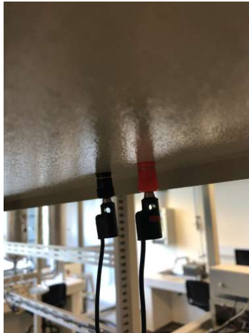
Figura 51: Salida multipunto del protocolo HART en el modulo de nivel. Fuente autor.
