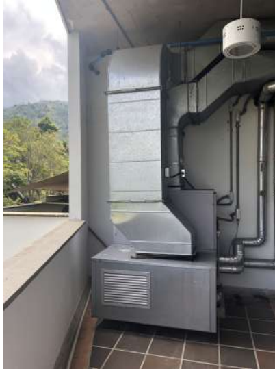
Figura 15: Servicio de aire acondicionado central. Fuente Autor.
