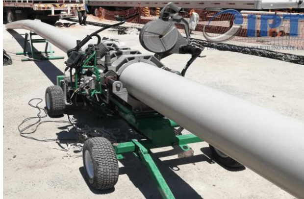
Ilustración 13. Tubería de polipropileno
