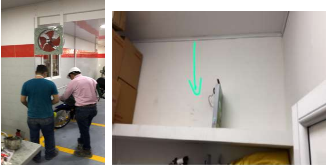
Imagen 20. Revisión de infiltraciones Honda
