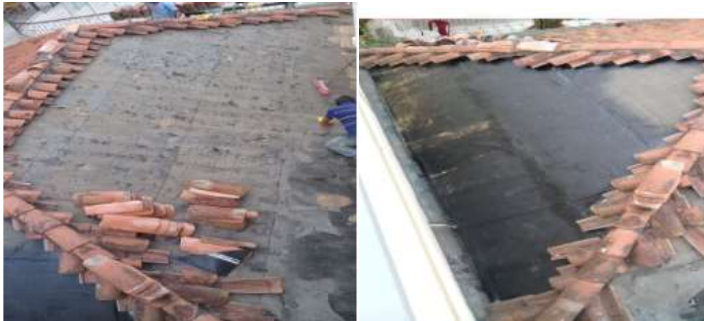
Imagen 25. Retiro de tejas y manto dañado San alonso señorial
