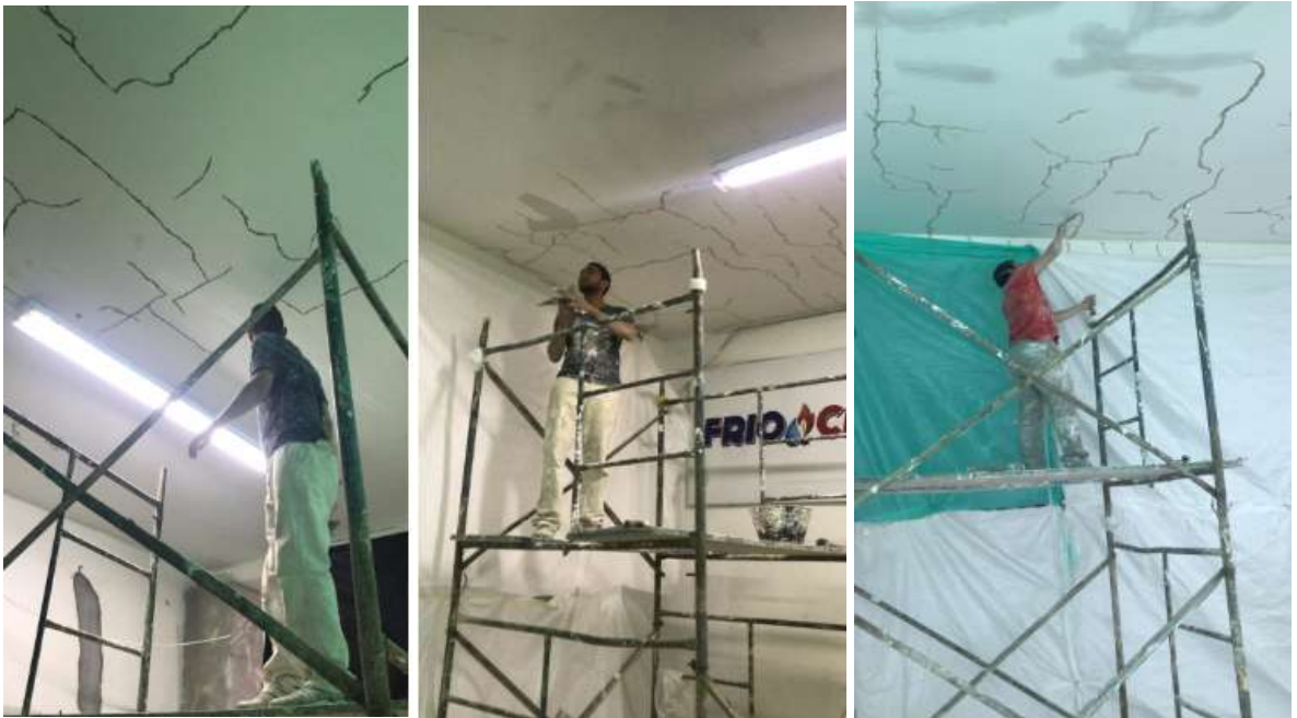
Imagen 18. Arreglos primer piso placa y paredes Frio y calor
