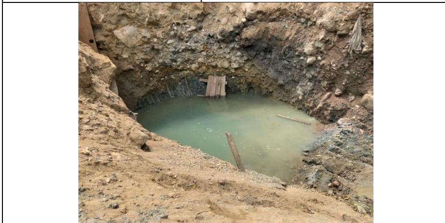
Fotografía 6. Inundaciones en tramos de excavación e instalación de tubería Fuente: Propia – amb S.A. E.S.P.
