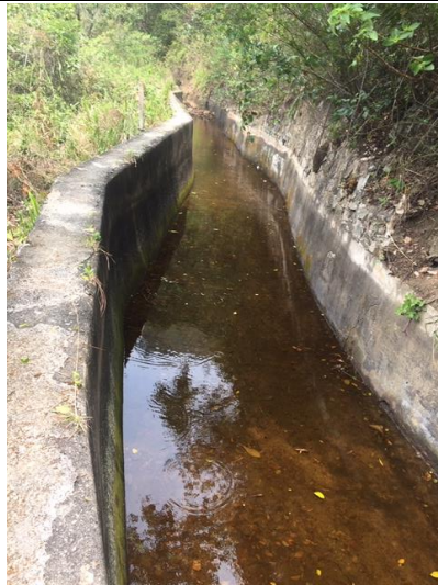
Fotografía 2. Acumulación de aguas lluvia en canal de la PCH Zaragoza Fuente: Propia – amb S.A. E.S.P.
