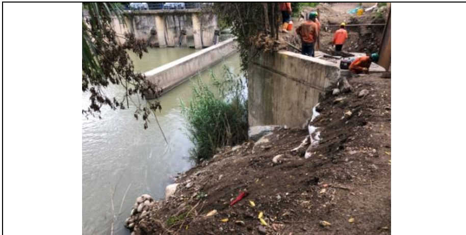
Fotografía 5. Desprendimiento de talud en sector PCH Fuente: Propia – amb S.A. E.S.P.
