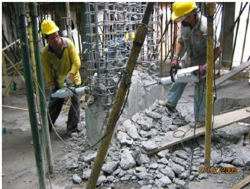
Foto No. Demolición de columnas por presentar resistencias bajas en el concreto.
