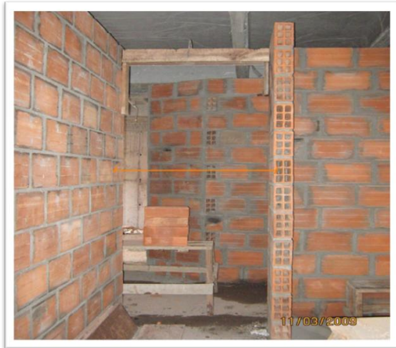
Foto 50. Cumplimiento de vanos.
