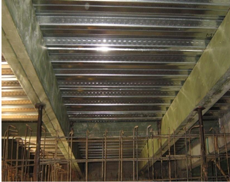
Foto 18. Vista inferior de la placa en steel deck.
