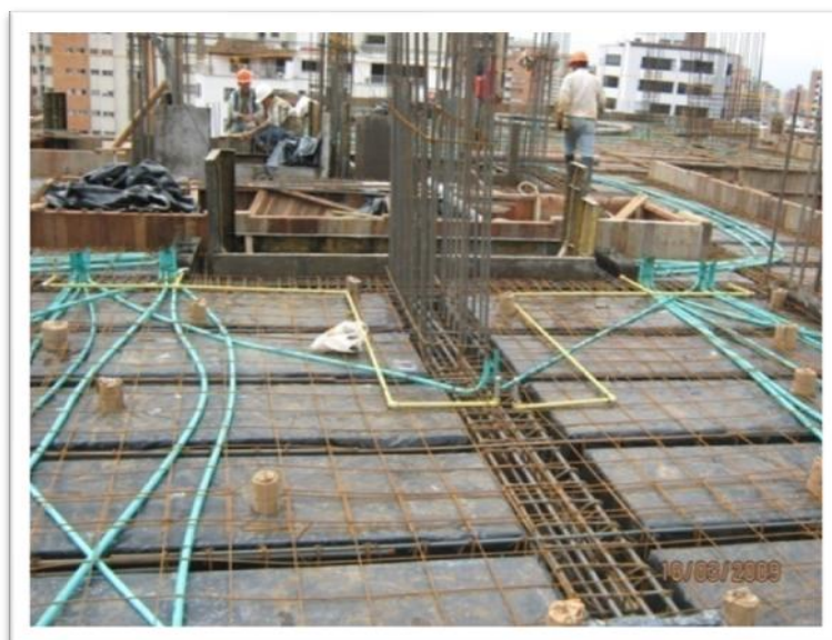
Foto 29. Instalación eléctrica y de gas (amarilla).
