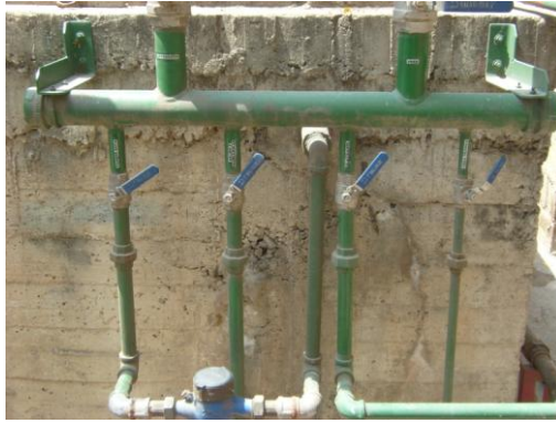
Figura 11. Señalización distribuidores de agua.
