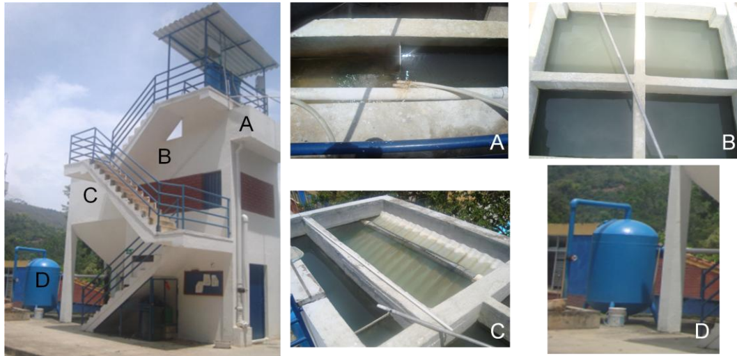
Figura 3. Reconocimiento partes de la PTAP Cajasan
