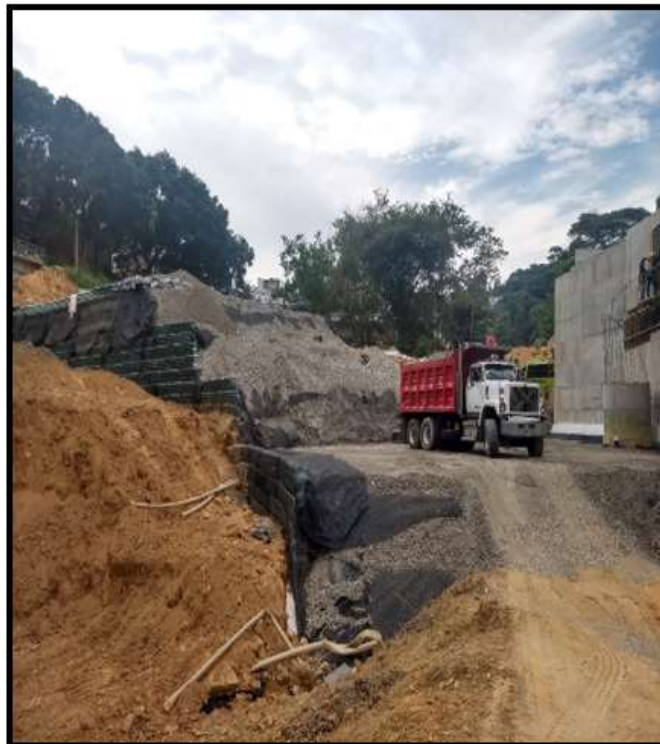
Figura 28. Primer registro, muros
