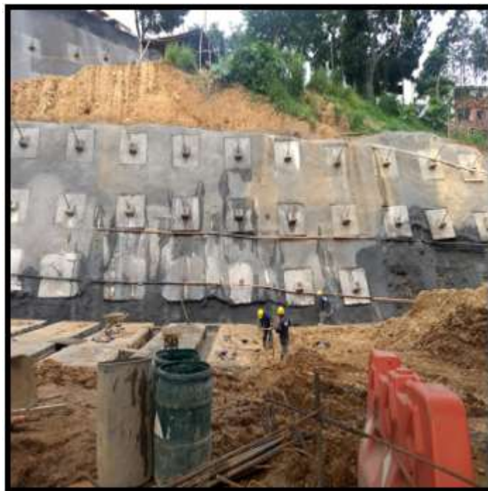
Figura 44. Anclajes San Bernardo
