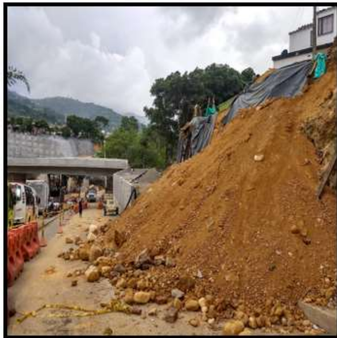
Figura 47. Talud barrio Alto Viento II
