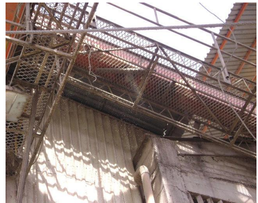
Figura 19. Fuga del TC - inclinado
