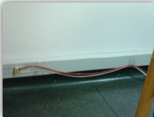
Figura 10. Riesgo de accidente, cableado sin canaletas.
