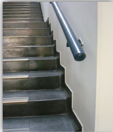
Figura 12. Riesgo de caída en diferente nivel por deslizamiento.
