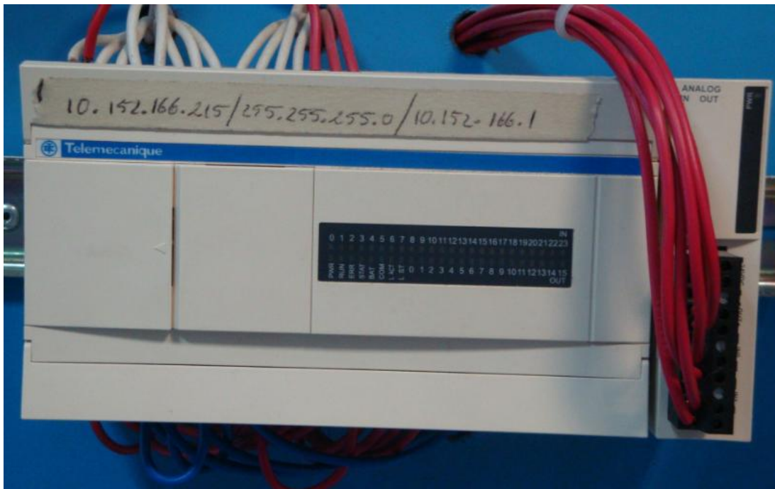
Figura 51. PLC TWDLCAE40DRF acoplado al modulo de entradas/salidas análogas TWDAMM3HT. Fuente autor.
