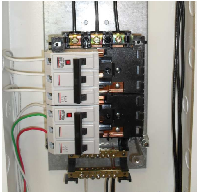
Figura 27. Taco Termomagnético Instalado en el Tablero de Automáticos. [50]
