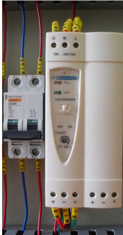
Figura 25. Fuente Telemecanique ABL8REM24050 instalada en el gabinete. [48]
