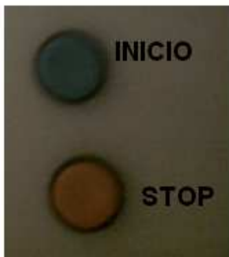
Figura 25: Botones de INICIO Y STOP ubicados a un costado del gabinete
