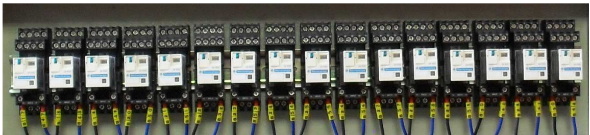
Figura 23. Instalación del Sistema de Acondicionamiento en el Gabinete. [46]
