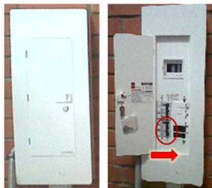
Figura 11: Activación del breaker tripolar
