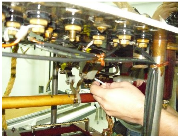
Figura 9. Transformador de alta tensión sede cuba. (Fuente de datos propios)
