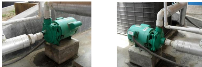
Figura 7 Bombas de \frac{1}{2} HP de potencia del modulo de aire acondicionado.
