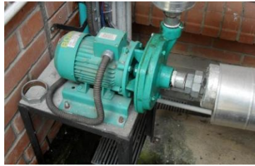
Figura 8 Bombas de 2 HP de potencia del modulo de aire acondicionado
