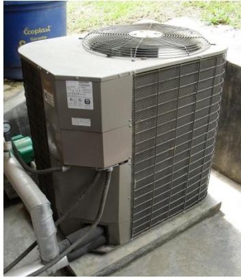
Figura 6 Chiller del modulo de aire acondicionado
