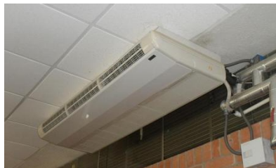
Figura 11 Fancoil del laboratorio de diseño del modulo de aire acondicionado.
