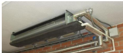
Figura 10 Fancoil del laboratorio de transferencia de calor del modulo de aire acondicionado.
