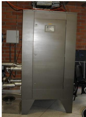
Figura 9 Unidad manejadora de aire del modulo de aire acondicionado.
