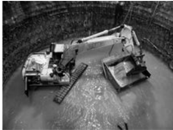
Figura 14. Inundación de una de las lumbreras por filtraciones
