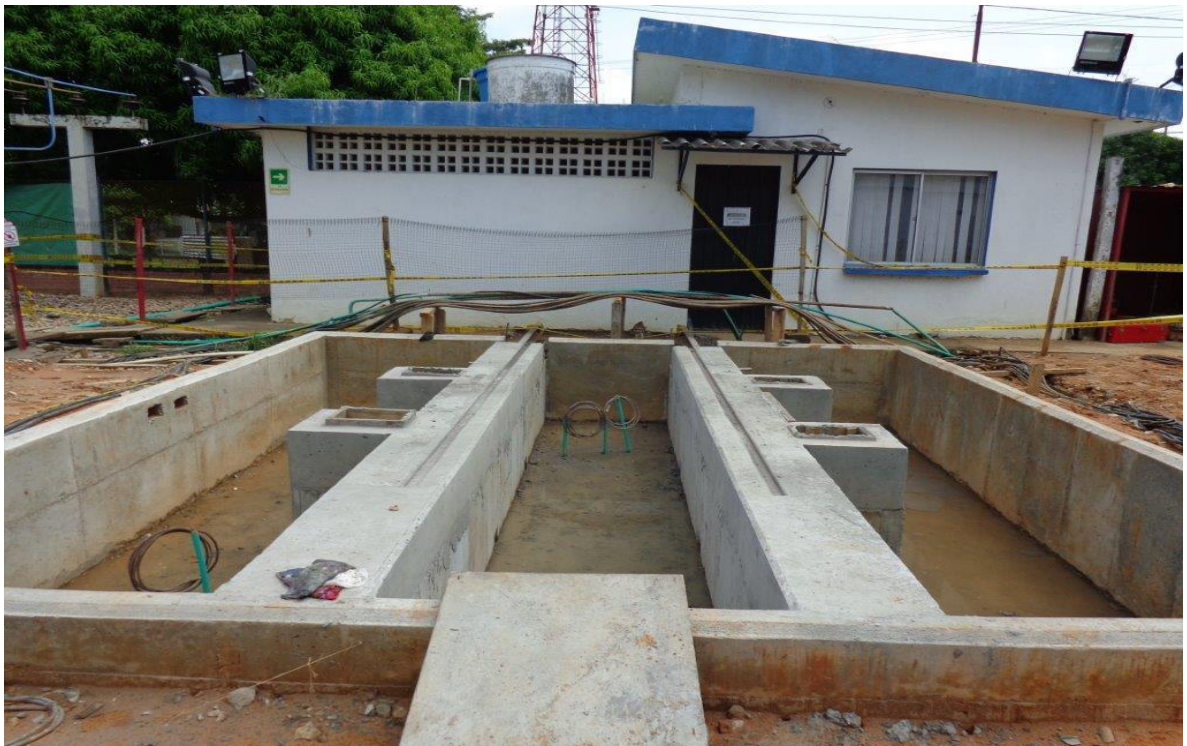
Figura 20. Cimentación y foso de un transformador de potencia. Fuente: Autor
