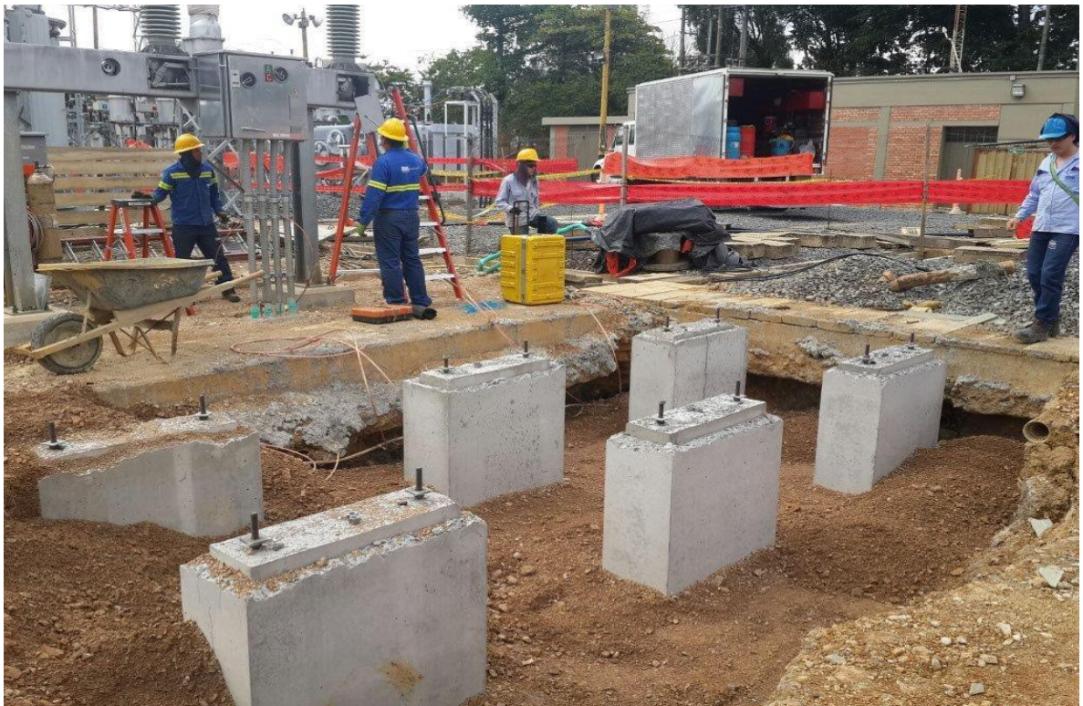
Figura 16. Cimentación y pedestal para un juego de seccionadores. Fuente: Autor.
