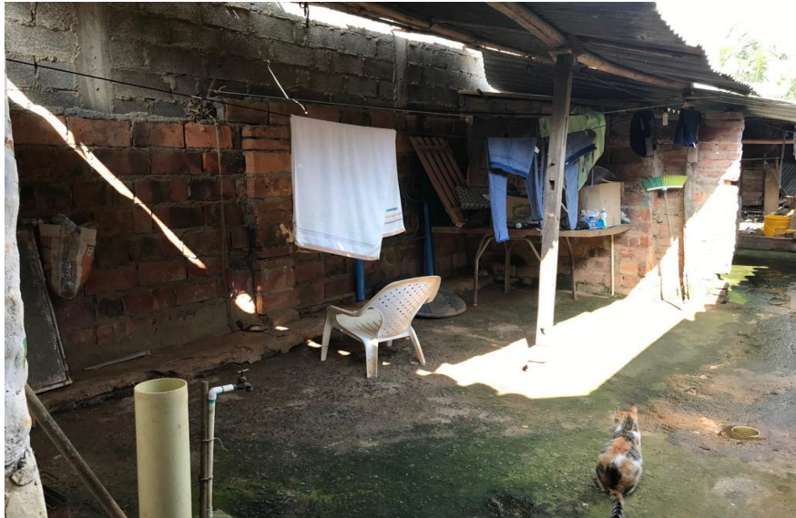
Imagen 23. Visita de inspección vivienda con problemas de humedad. Fuente: Autor.
