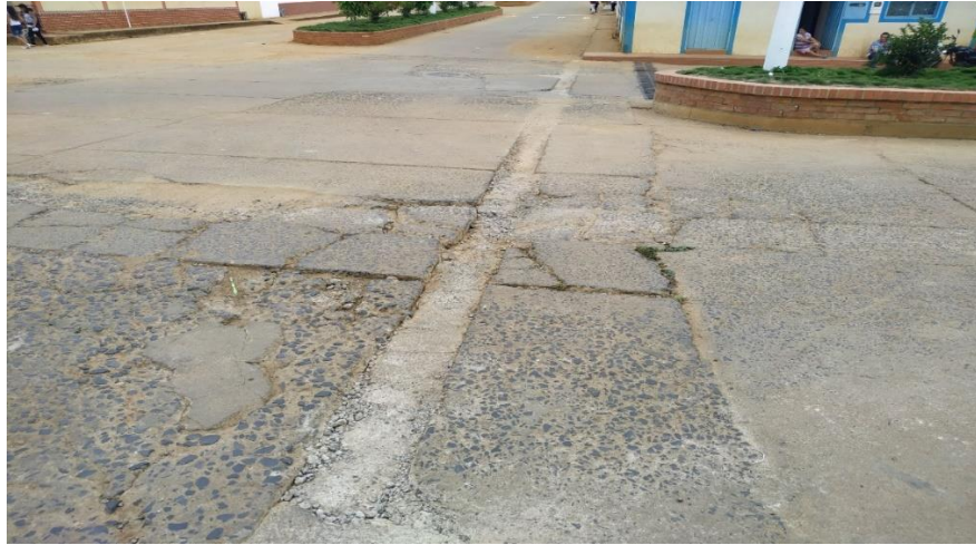
Imagen 30. Visita de inspección en calle del municipio debido a hundimiento y fracturación del pavimento debido a intervención de red de gas. Fuente: Autor.
