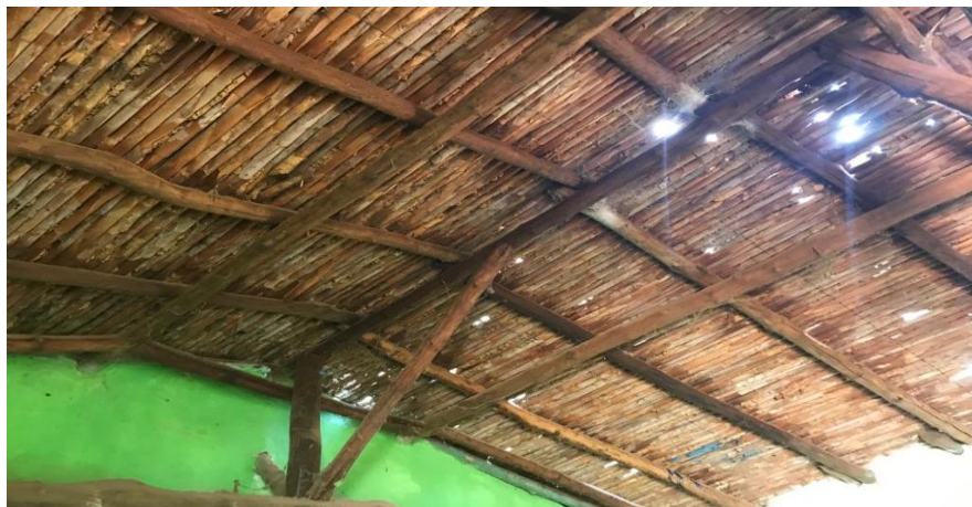
Imagen 25. Visita de inspección a vivienda con problemas de cubierta. Fuente: Autor.
