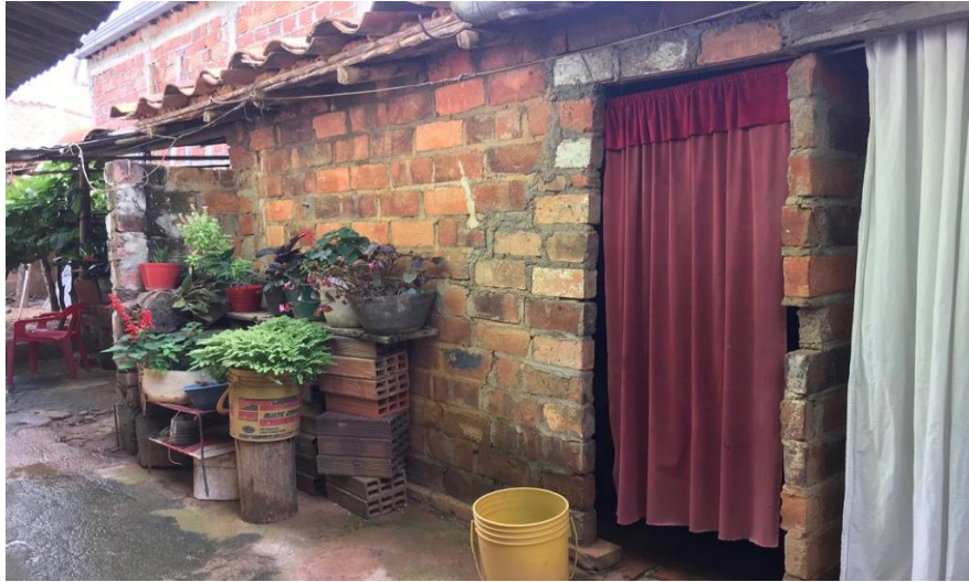
Imagen 24. Visita de inspección vivienda con problemas de humedad. Fuente: Autor.
