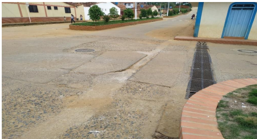
Imagen 29. Visita de inspección en calle del municipio debido a hundimiento y fracturación del pavimento por intervención de red de gas. Fuente: Autor.
