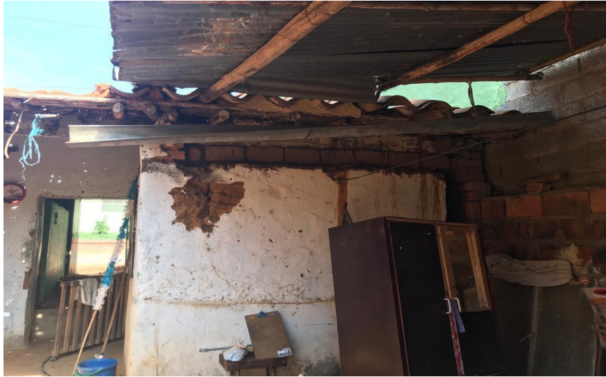
Imagen 22. Visita de inspección vivienda con problemas de humedad. Fuente: Autor.
