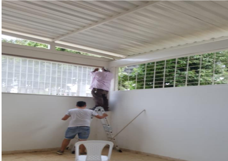
Imagen 6. Inspección obra de mejoramiento en el Colegio Eliseo Pinilla Rueda. Fuente: Autor.
