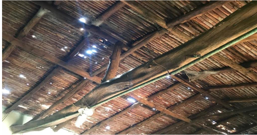
Imagen 26. Visita de inspección a vivienda con problemas de cubierta. Fuente: Autor.
