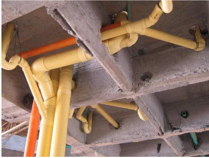
Figura 56– Uniones de tuberías
