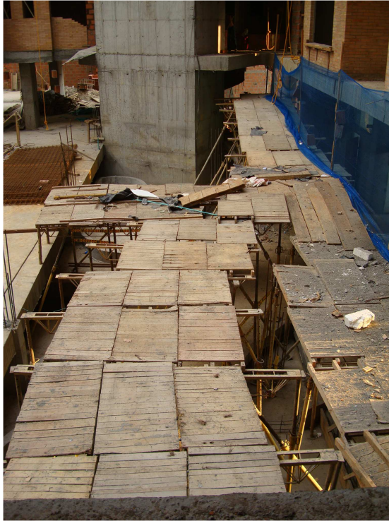
Figura 65- Protección en los pasillos de circulación principal
