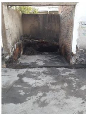
Figura 6. Cuarto de almacenamiento de cenizas
