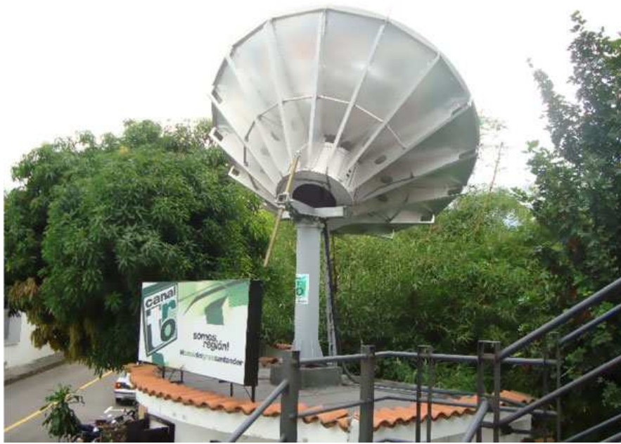
Figura 23. Antena de foco primario para comunicación satelital ubicada en sobre el cuarto de Up-Link. Cortesía Canal TRO Ltda.
