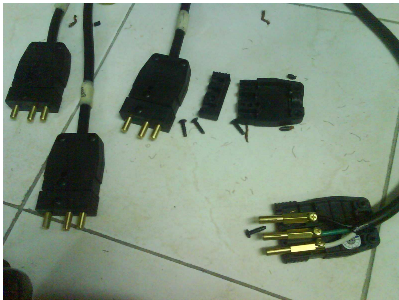
Figura 59. Conectores TRIPIN de los Dimmers
