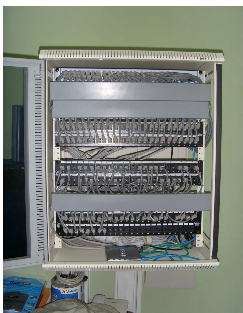
Figura 65. Rack de Comunicaciones.
