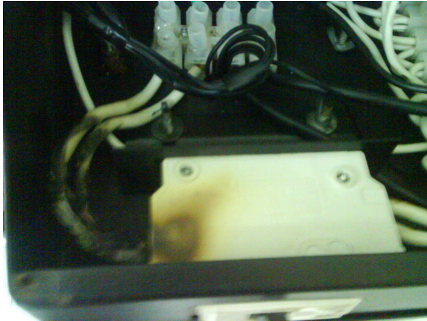
Figura 58. Breaker quemado dentro de la Caja de Encendido ON/OFF.
