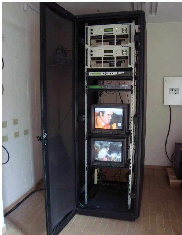
Figura 22. Cuarto de Up-Link.
