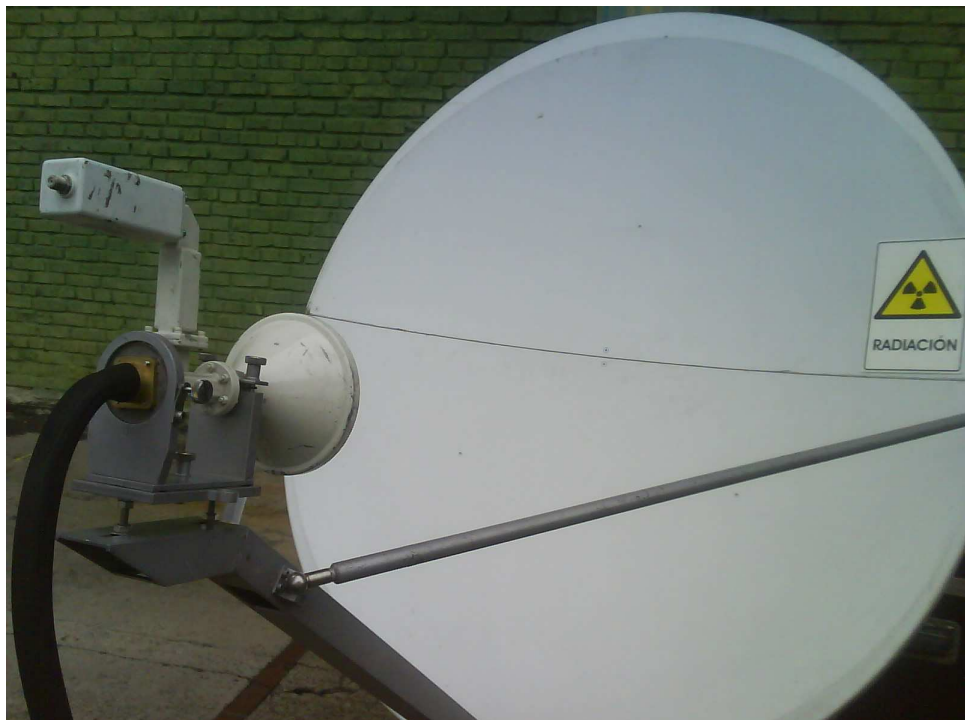
Figura 81. Antena Fly Away para transmisión Vía Satélite ubicada en las proximidades del estadio Daniel Zapata en la ciudad de Barrancabermeja.
