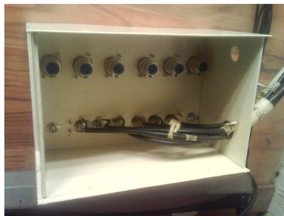
Figura 42. Caja distribuidora de Audio y Video del Set #1 en Mantenimiento.
