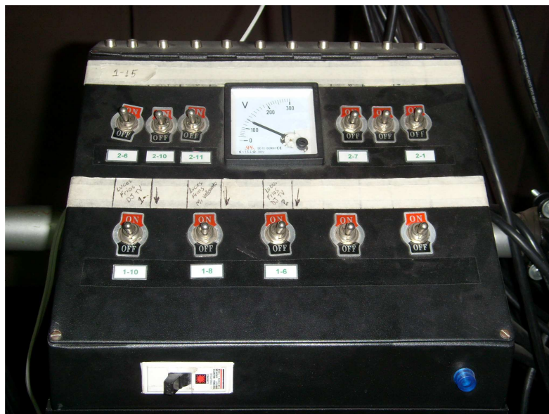
Figura 55. Caja de Encendido de Luces tipo ON / OFF.
