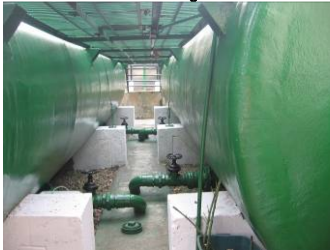
Fotografía 9. Planta de tratamiento de aguas residuales
