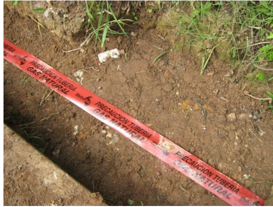
FIGURA 1: Señalización para la identificación de la tubería.
