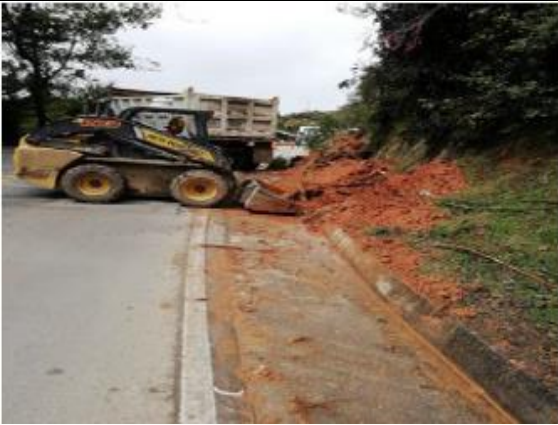
Imagen 37 Recolección de material producto de deslizamiento
