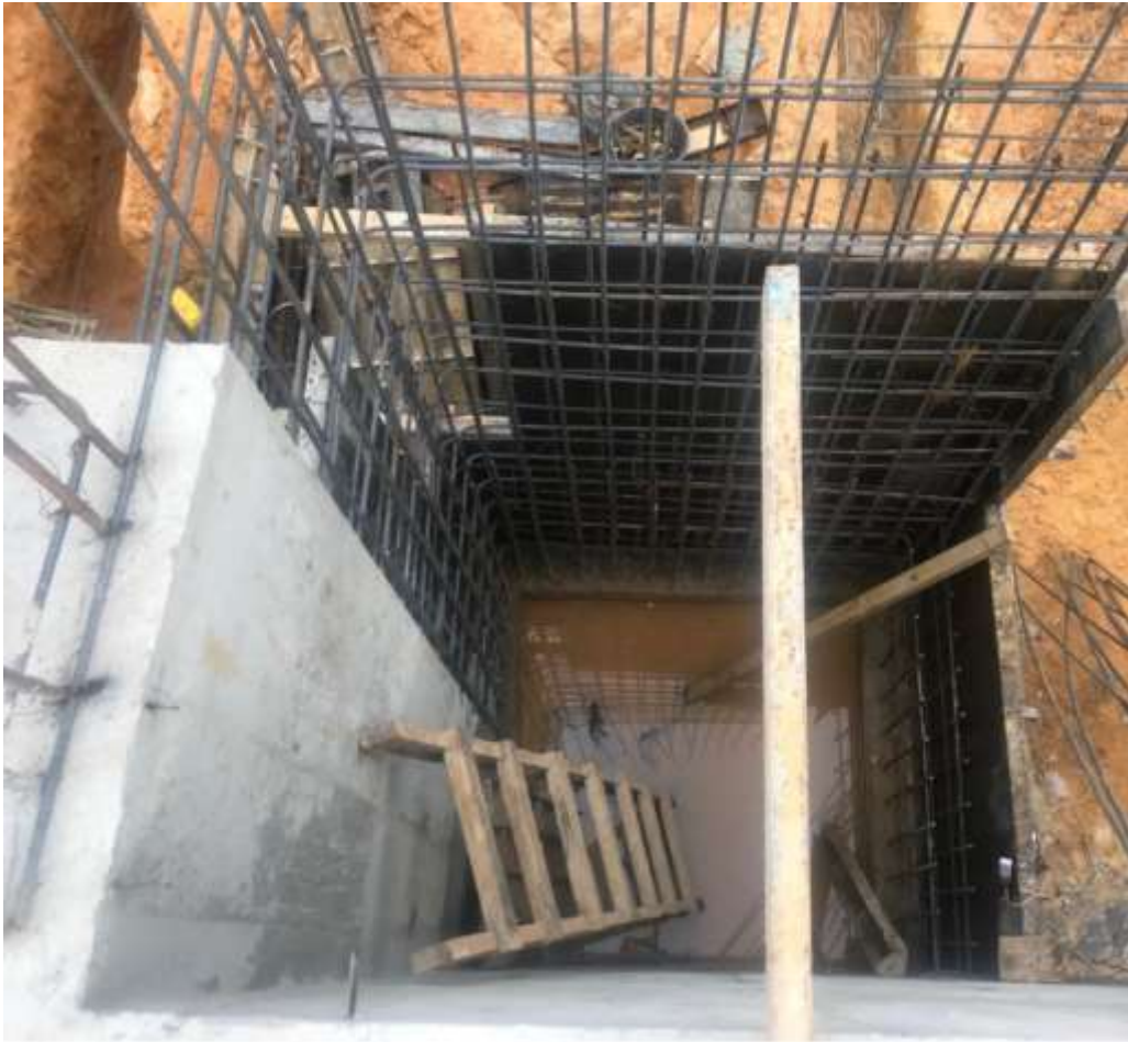
Ilustración 9. Inundación de la obra por lluvias
