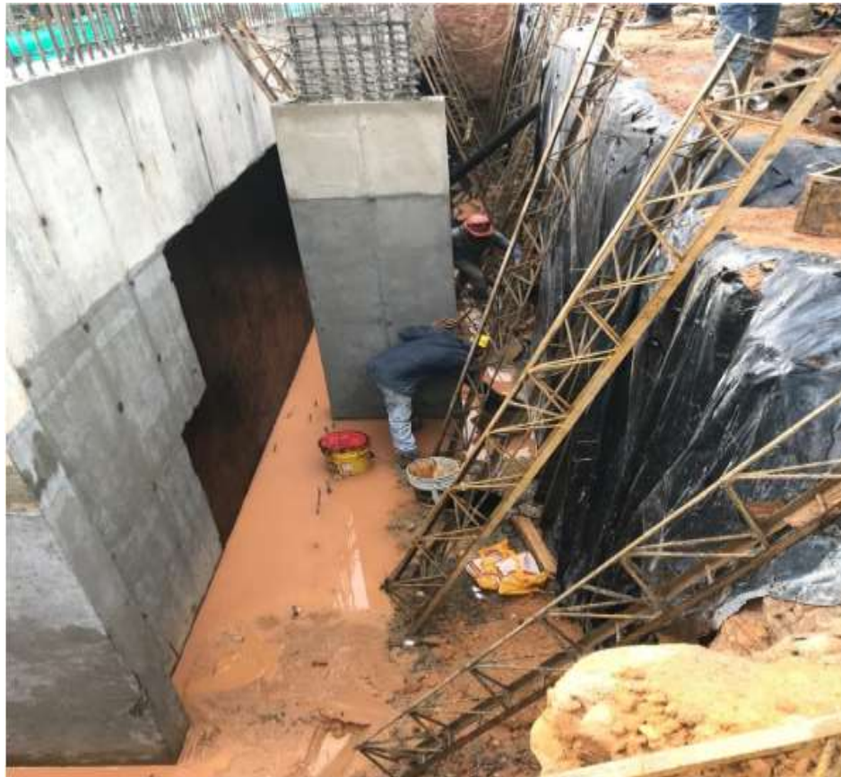
Ilustración 8. Inundación de la obra por lluvias
