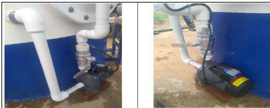
Ilustración 114. Instalación Electrobomba Nueva Pequeña - Vereda La Aguada Fuente: Propia
