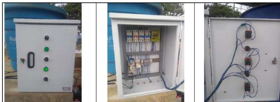
Ilustración 115. Cuadro de Control y Manejo del Sistema del Tanque - Vereda La Aguada Fuente: Propia
