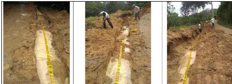
Ilustración 97. Suministro e Instalación Tubería PVC 1 1/2" E.L. RDE 21 4 - Vereda Aguirre Bajo Fuente: Propia
