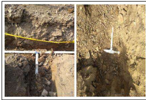
Ilustración 174. Tee Hf de 2x2" 1 - Corregimiento Santo Domingo El Ramo Fuente: Propia
