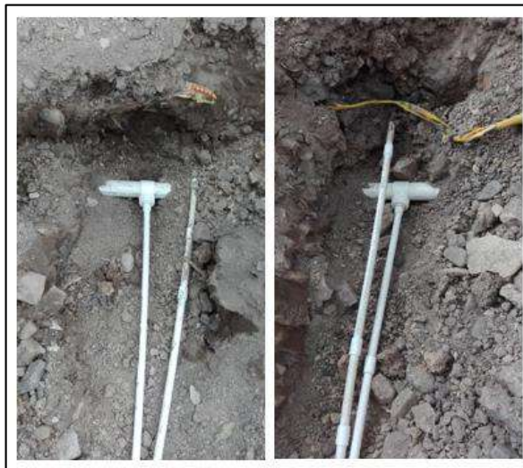
Ilustración 175. Tee Hf de 2x2" 2 - Corregimiento Santo Domingo El Ramo Fuente: Propia
