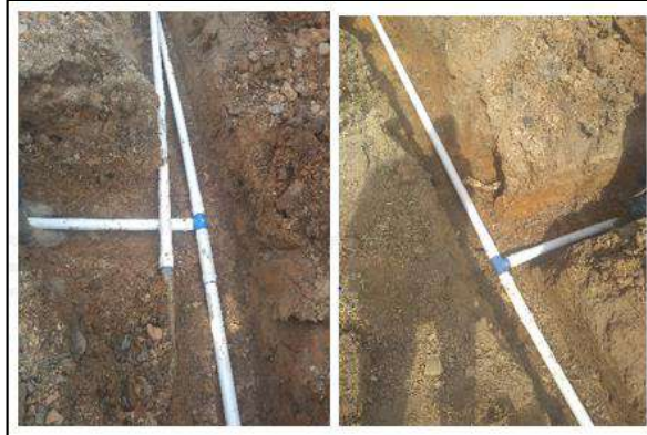
Ilustración 173. Tee Hf de 2x2" - Corregimiento Santo Domingo El Ramo Fuente: Propia
