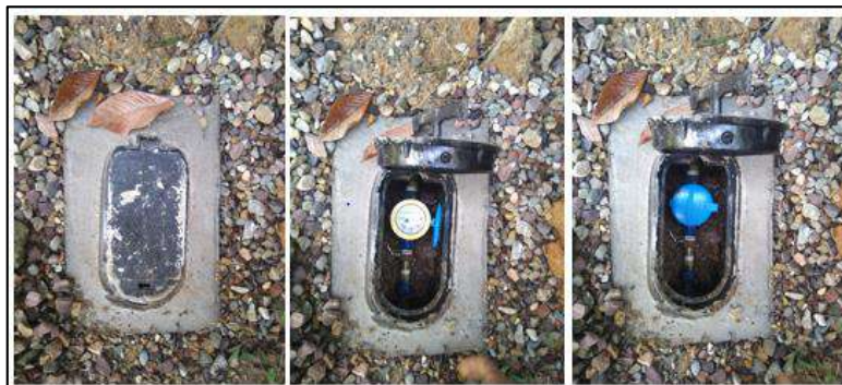
Ilustración 168. Micromedidor - Corregimiento Santo Domingo El Ramo Fuente: Propia
