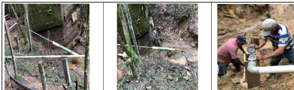
Ilustración 120. Adecuaciones de la Comunidad - Instalación de Tubería y Válvula - Vereda Altos de Palo Negro Fuente: Propia
