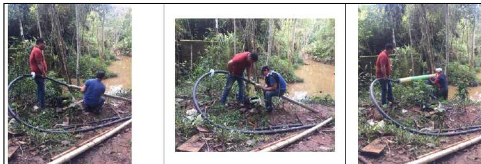
Ilustración 119. Adecuaciones de la Comunidad - Instalación de Tubería Conexión Electrobomba - Vereda Altos de Palo Negro Fuente: Propia
