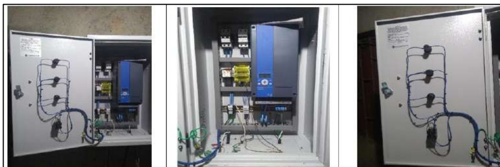
Ilustración 117. Cuadro Eléctrico con Arranque Automático Instalado - Vereda La Aguada Fuente: Propia
