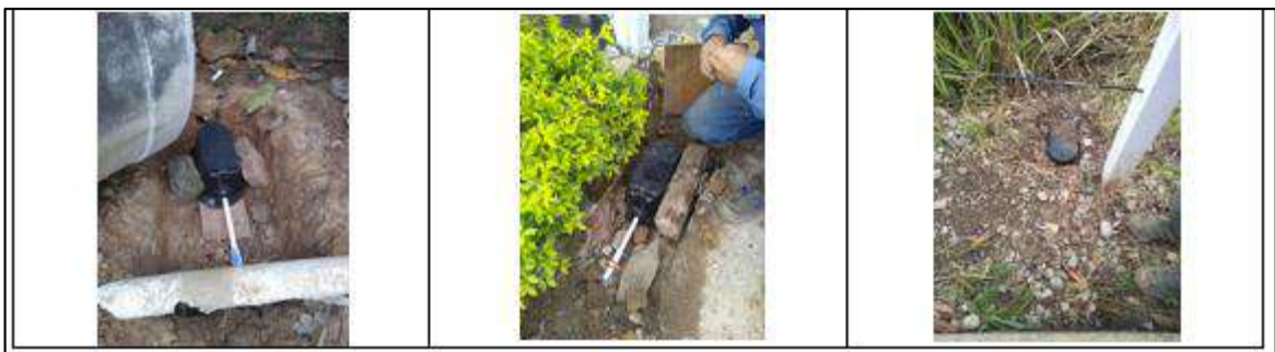
Ilustración 85. Micromedidor y Caja 2 - Vereda Cerro de la Aurora Fuente: Propia
