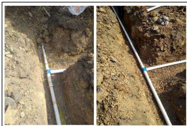
Ilustración 176. Tee Hf de 2x2" 3 - Corregimiento Santo Domingo El Ramo Fuente: Propia
