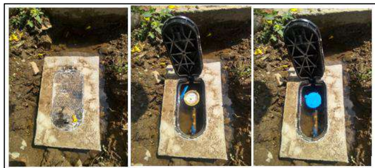
Ilustración 172. Micromedidor 4- Corregimiento Santo Domingo El Ramo Fuente: Propia
