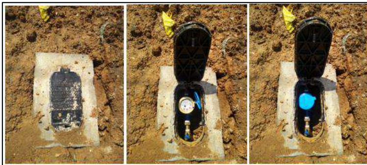
Ilustración 169. Micromedidor 1- Corregimiento Santo Domingo El Ramo Fuente: Propia
