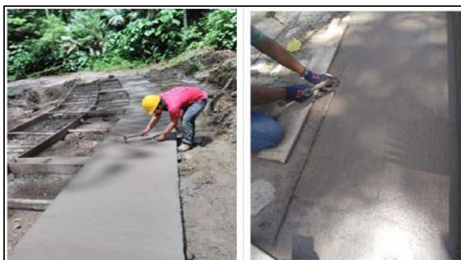
Ilustración 63. Dilataciones Huellas y Cunetas – Vereda La Pitala Fuente: Propia
