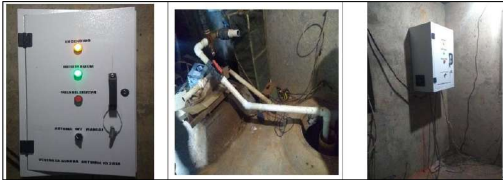
Ilustración 118. Cuadro Eléctrico con Arranque Automático Instalado con conexión a Motobomba - Vereda La Aguada Fuente: Propia
