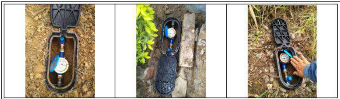
Ilustración 84. Micromedidor y Caja 1 - Vereda Cerro de la Aurora Fuente: Propia
