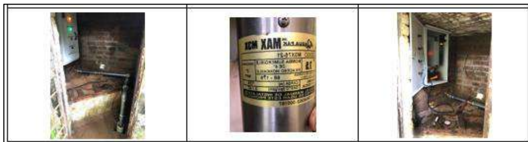
Ilustración 102. Cuadro Eléctrico 1 - Vereda San Lorenzo Fuente: Propia
