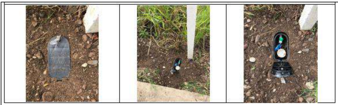
Ilustración 83. Micromedidor y Caja - Vereda Cerro de la Aurora Fuente: Propia
