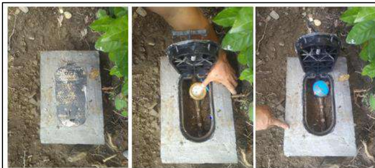
Ilustración 170. Micromedidor 2- Corregimiento Santo Domingo El Ramo Fuente: Propia
