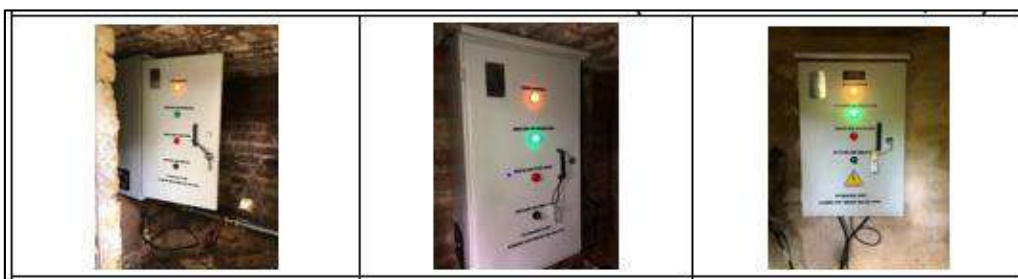
Ilustración 101. Cuadro Eléctrico - Vereda San Lorenzo Fuente: Propia
