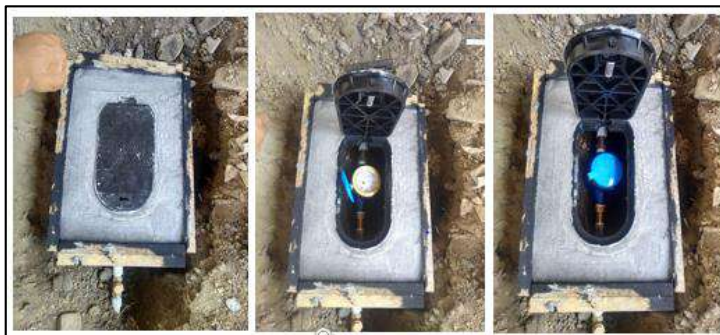
Ilustración 171. Micromedidor 3- Corregimiento Santo Domingo El Ramo Fuente: Propia
