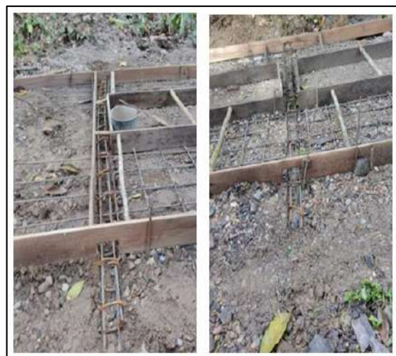
Ilustración 50. Formaleta y Figurado de Acero Vigas Riostras Cortas – Vereda La Pitala Fuente: Propia
