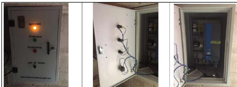
Ilustración 122. Cuadro Eléctrico con Arranque Automático Instalado - Vereda Altos de Palo Negro Fuente: Propia
