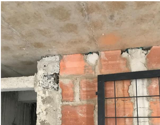
Foto 20. Hormiguero en columneta
