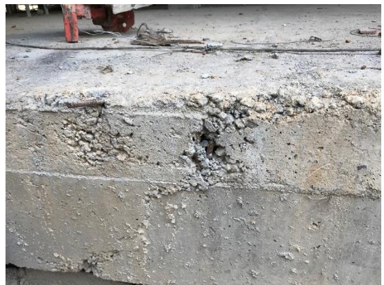
Foto 21. Hormiguero en placa maciza
