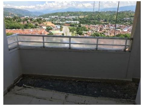
Foto 32. Barandas para balcones de apartamentos
