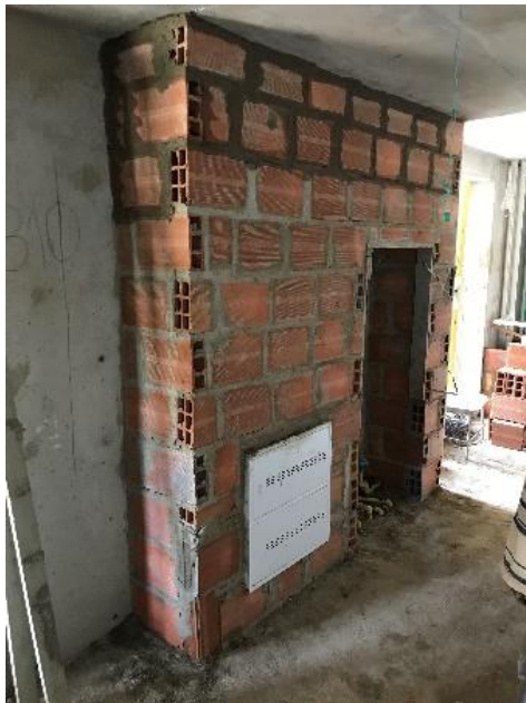
Foto 3. Buitrón con unidades mal trabadas
