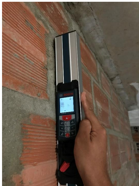
Foto 4. Zona del muro fuera de tolerancias de verticalidad
