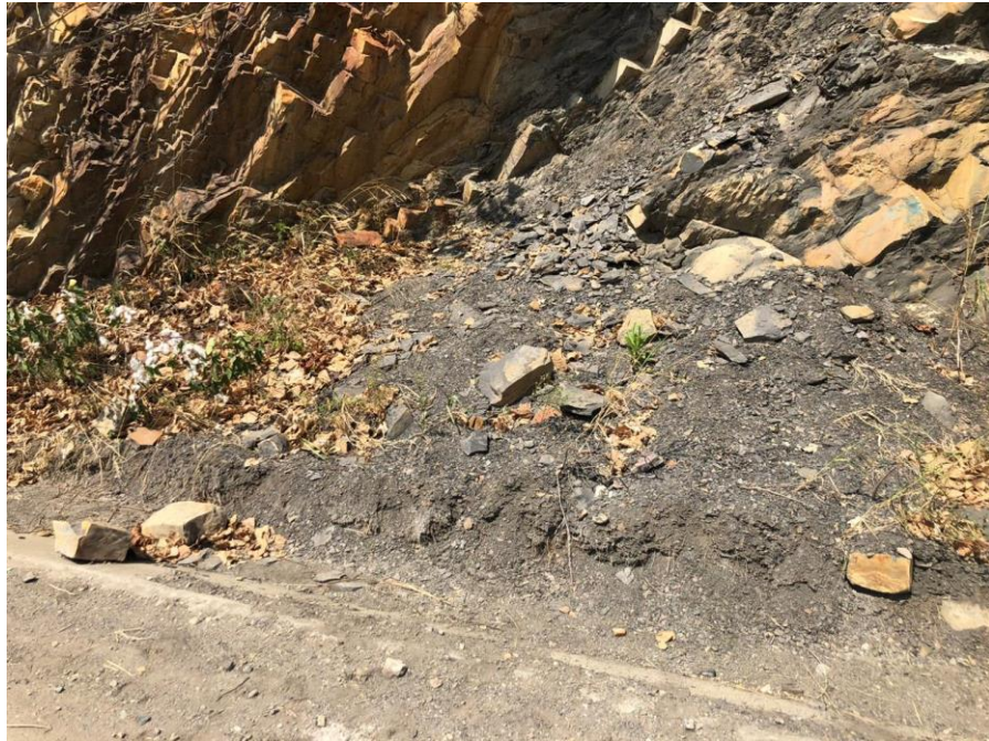
Figura 3. Desprendimientos de rocas sobre el pie del talud.
