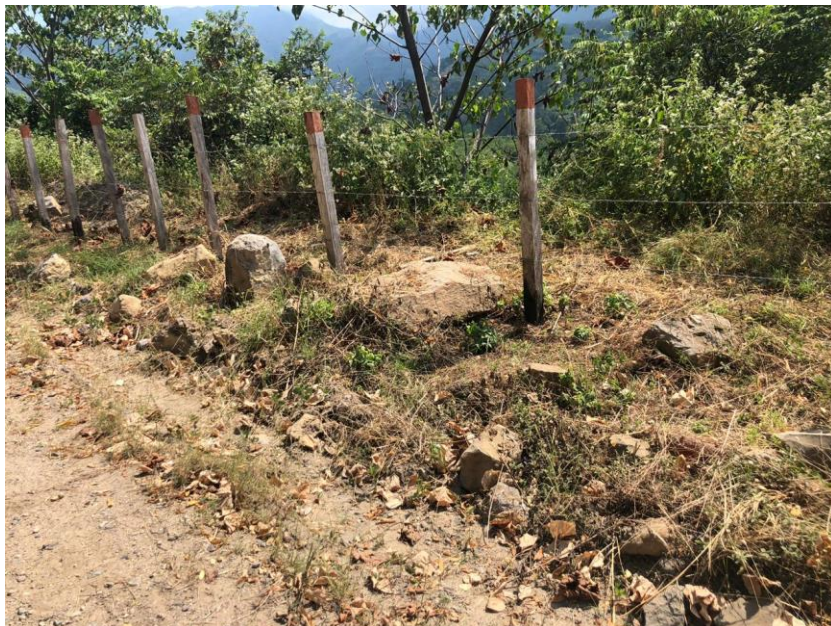
Figura 4. Desprendimientos de rocas sobre la vía que conduce a Betulia-Santander.
