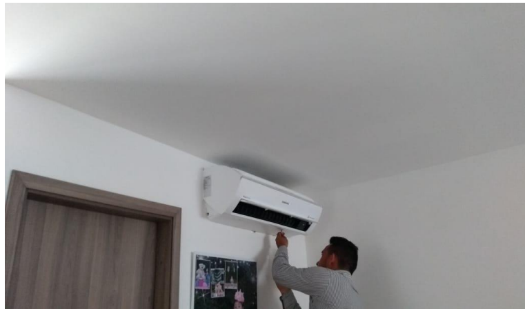
Ilustración 5. Identificación del equipo y toma de medidas de voltaje
