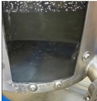
Figura 12. Fuga hermética dos del tanque tres.
