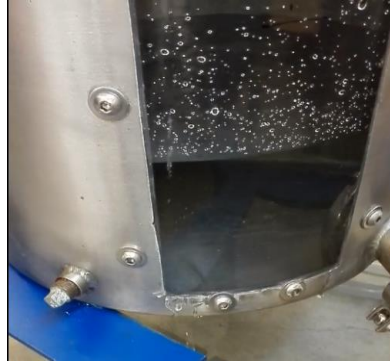
Figura 11. Fuga hermética uno del tanque tres.
