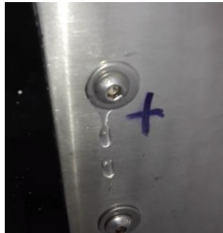
Figura 9. Fuga hermética dos del tanque cuatro
