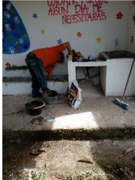
Imagen 5. Aplicación de friso en la zona de lavado de la Escuela El Tambor Fuente: Elaboración propia – Visita a obra.
