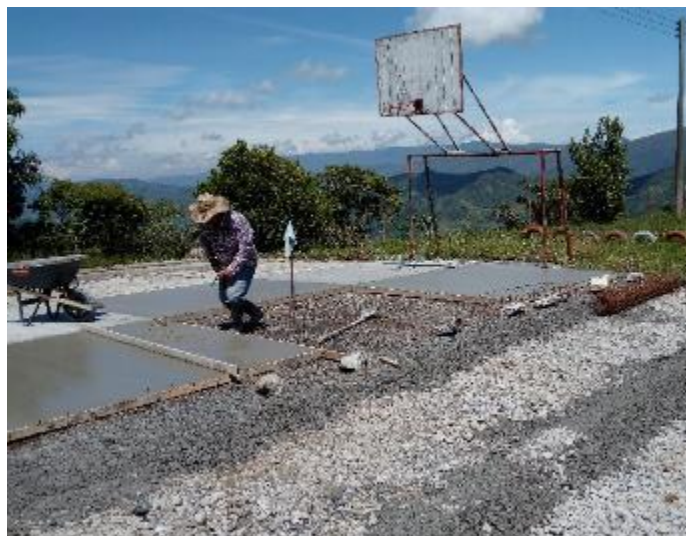
Imagen 17. Vaciado del concreto para placa de cancha de la Escuela El Salitre
