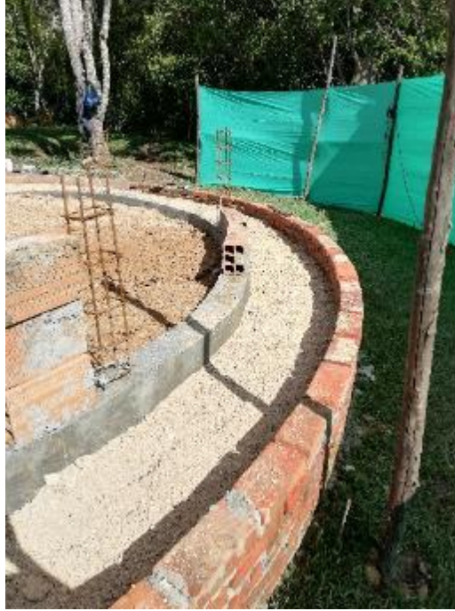
Imagen 19. Muro de mampostería confinada del Quiosco Lucas Caballero Fuente: Elaboración propia – Visita a obra.
