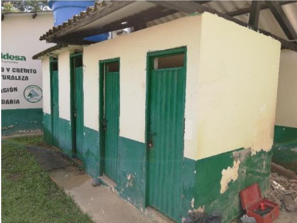
Imagen 24. Fachada existente de los baños de la Escuela Santa Rita Fuente: Elaboración propia – Visita a obra.
