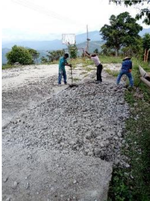
Imagen 15. Demolición de la placa de cancha de la Escuela El Salitre Fuente: Elaboración propia – Visita a obra.
