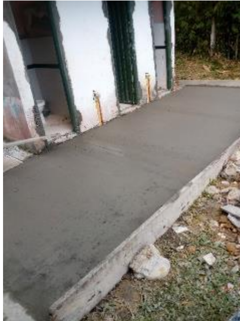
Imagen 7. Placa de contrapiso de la Escuela El Tambor
