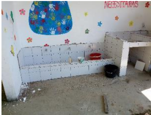
Imagen 9. Enchape terminado en la zona de lavado de la Escuela El Tambor Fuente: Elaboración propia – Visita a obra.
