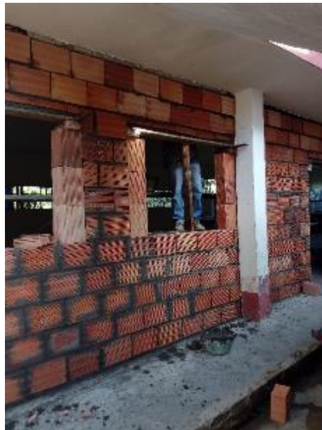
Imagen 13. Muro en mampostería en el Restaurante escolar San José de Suaita Fuente: Elaboración propia – Visita a obra.
