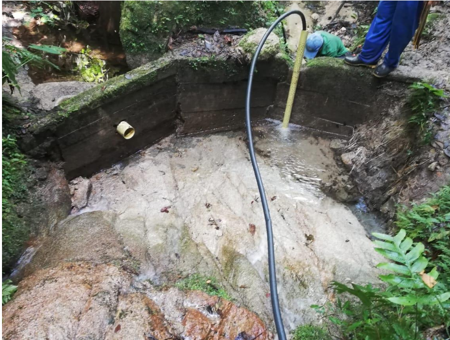
Imagen 14. Bocatoma quebrada La Azufrada.
