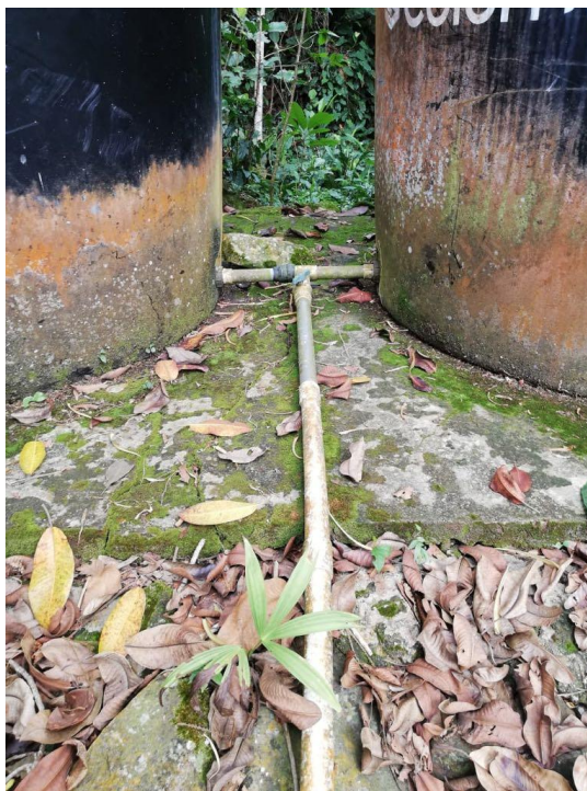
Imagen 36. Salida a caserío del lado derecho de la vía, red matriz.
