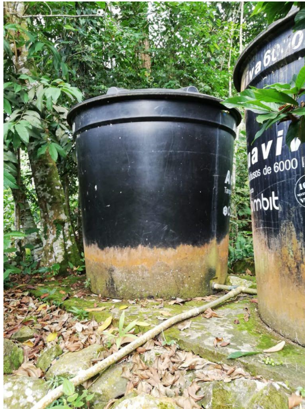
Imagen 35. Tanques repartidores 2 actuales.
