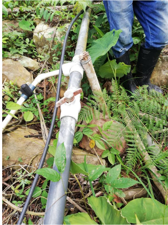
Imagen 27. Cruce de tuberías para surtir tanques distribuidores.
