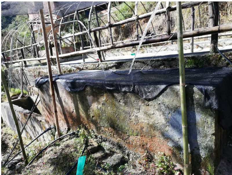
Imagen 18. Tanque de distribución.
