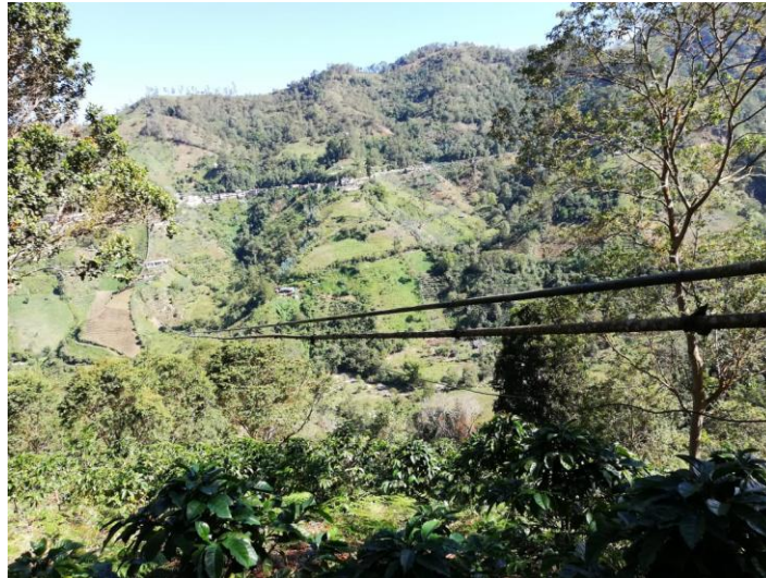
Imagen 17. Tubería de abastecimiento aérea.
