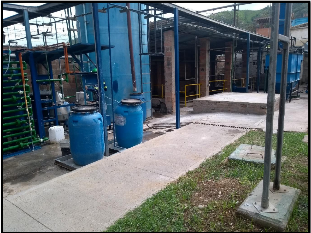
Fotografía 4. Planta de tratamiento de aguas industriales de SACEITES
