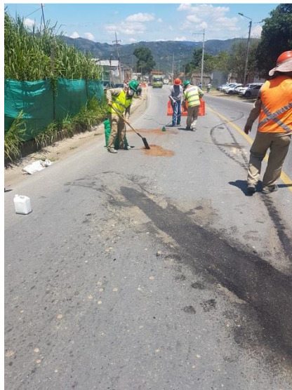
Figura 6. Acción de control de derrames por parte de la Brigada de orden, aseo y limpieza, Av. Libertador.
