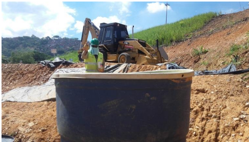
Figura 9. Tanque de almacenamiento de agua de talud, Plataforma de acceso.
