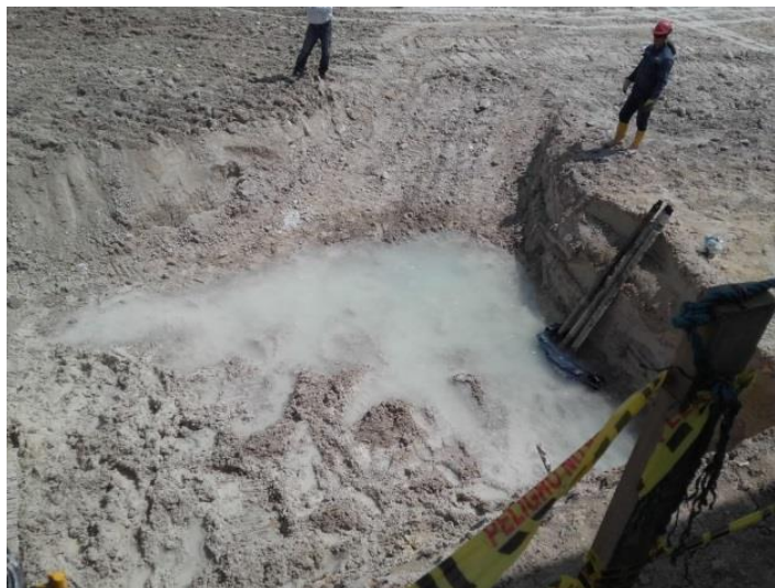
Figura 10. Afloramiento de agua en Pantalla anclada del talud sur, Patio Taller.
