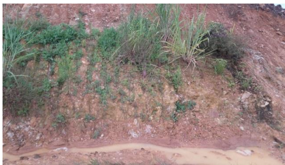
Figura 8. Agua proveniente de talud.
