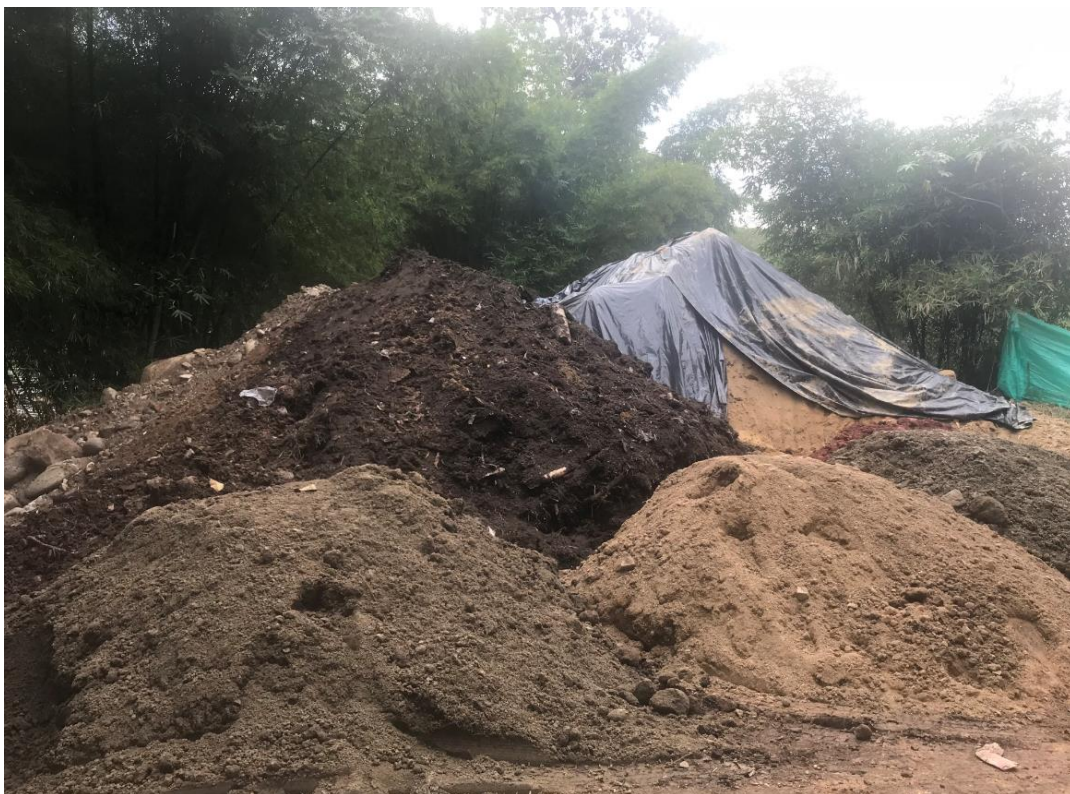
Figura 2 Inadecuado acopio de escombros y material de relleno
