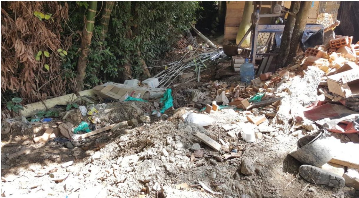
Figura 6 Incorrecto acopio de residuos
