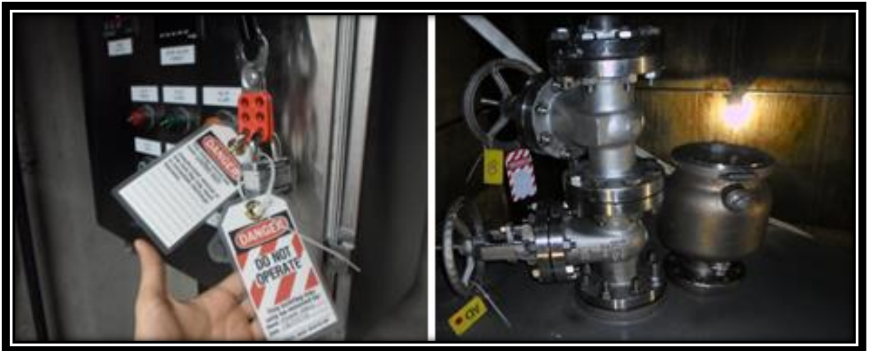
Figura 4: Etiquetas de las máquinas Izquierda - Lockout/Tagout, que indica: equipo bloqueado, no manipular Derecha - Nombre de las válvulas, indican también su posición (Fuente: El autor)
