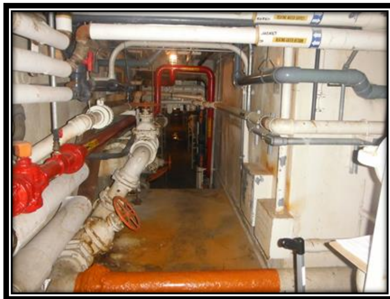
Figura 9: Sección del túnel que comunica el edificio administrativo con los digestores de lodos.
