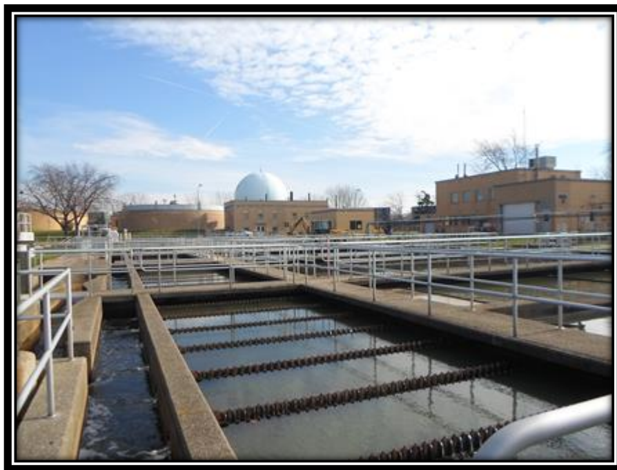
Figura 8: Clarificadores de Agua Residual de Thorn Creek
