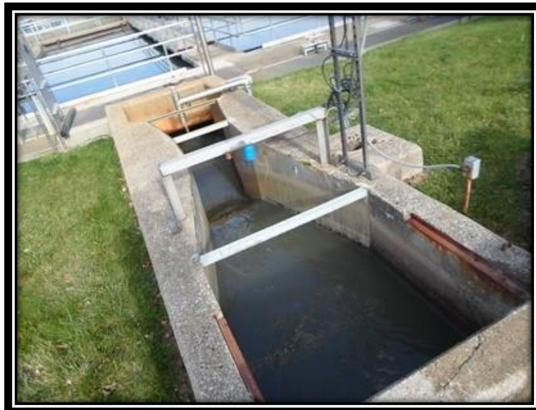
Figura 7: Uno de los puntos de muestreo - Canaleta Parshall con el afluente doméstico entrando a los clarificadores primarios
