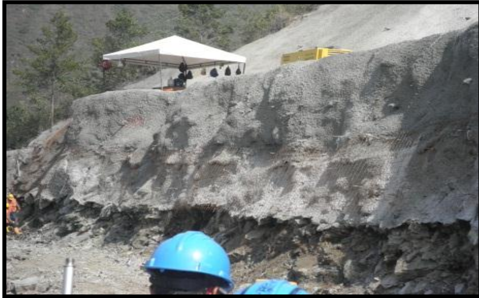
FOTOGRAFIA 21. Estado del EDE En explotación.
