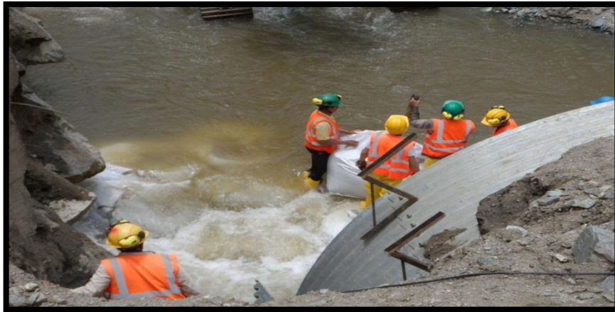
FOTOGRAFIA 118. Anclaje de la tubería ARMCO
