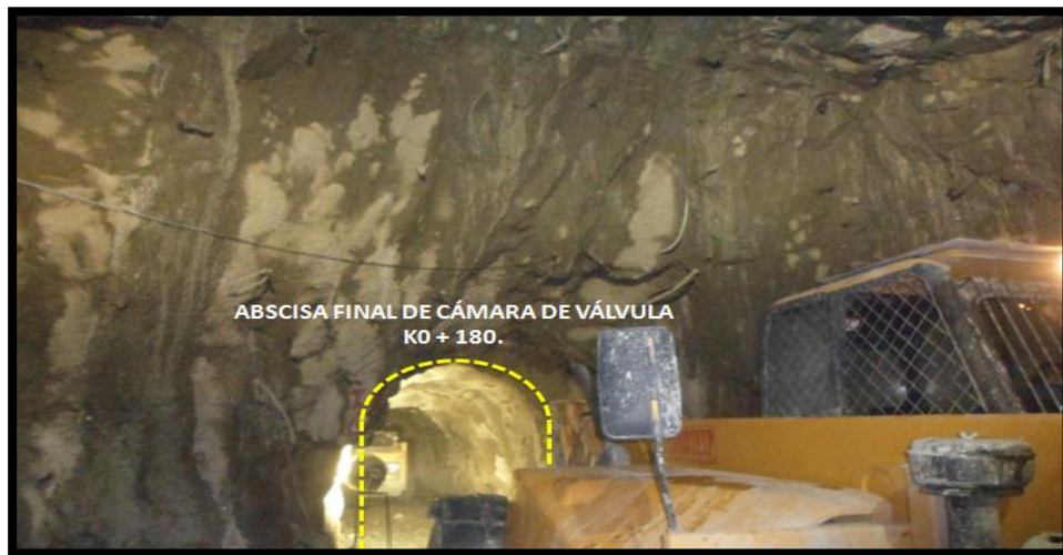
FOTOGRAFIA 11. Cámara de válvulas
