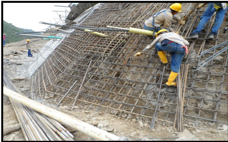
FOTOGRAFIA 93. Arreglo de malla en el costado de derecho de la pantalla
