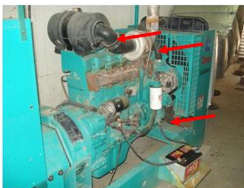
Figura 16. Tuberías de aire
