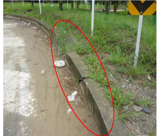
Imagen N° 22 Sentido Retorno La Rioja – Retorno Platacero (Andén Fracturado)
