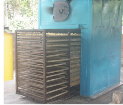
Figura 8.2: Fotografía del horno de la planta de Cimitarra
