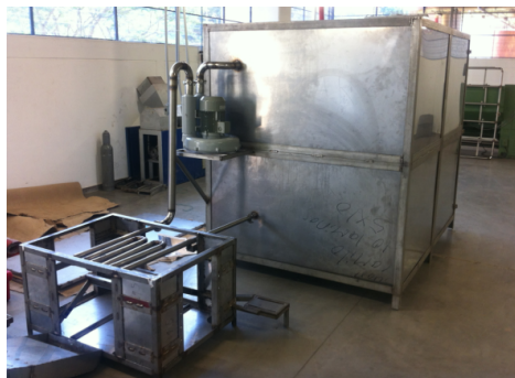
Figura 6.13: Fotografía de los paneles instalados
