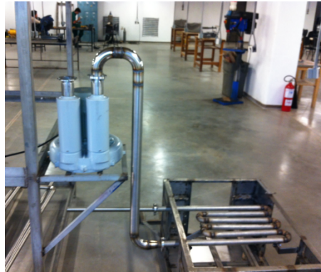
Figura 6.10: Fotografía de la turbina en sitio.
