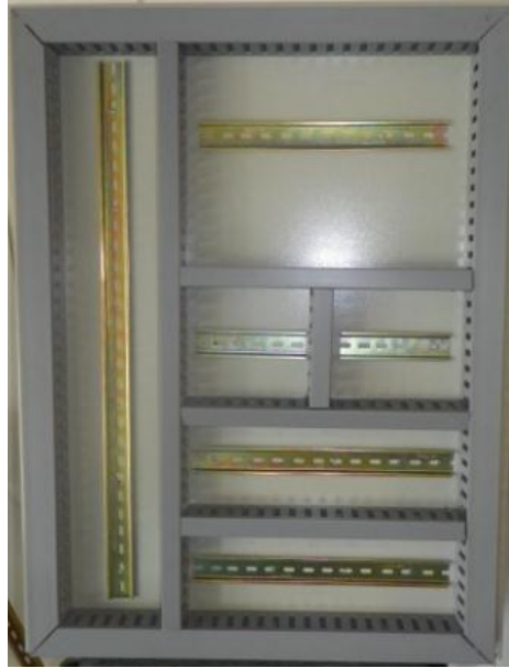
Figura 7. Gabinete principal calle de selección
