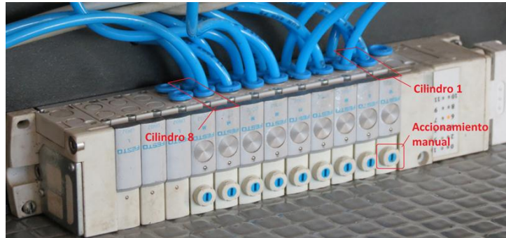
Figura 34. Isla de válvulas
