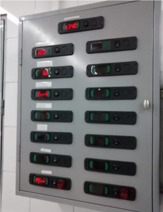
Figura 8. Gabinete de Dataloggers para control de cabina climatizada.
