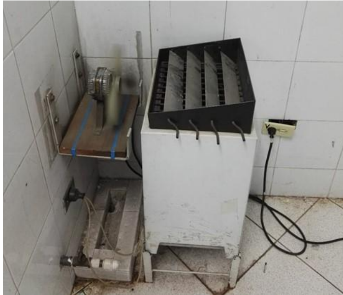
Figura 5. Caja de resistencias de la cabina climatizada
