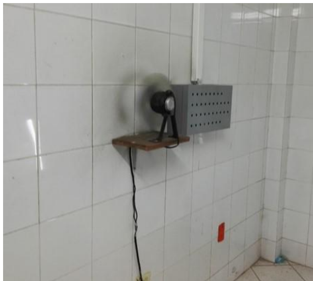
Figura 6. Ventilador de la cabina climatizada.
