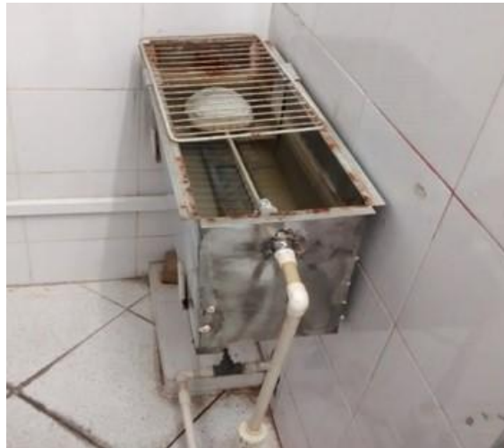
Figura 4. Tanque con resistencia generadora de humedad en la cabina.
