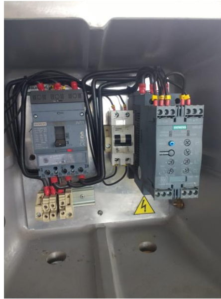
Figura 9. Sistema eléctrico arrancador suave
