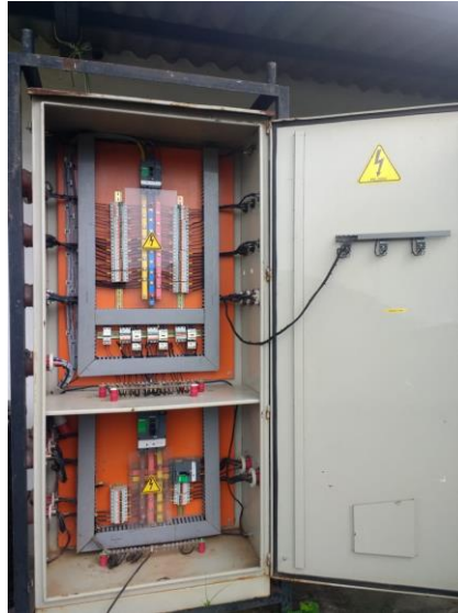
Figura 4. Tablero distribución eléctrica 440v/220v
