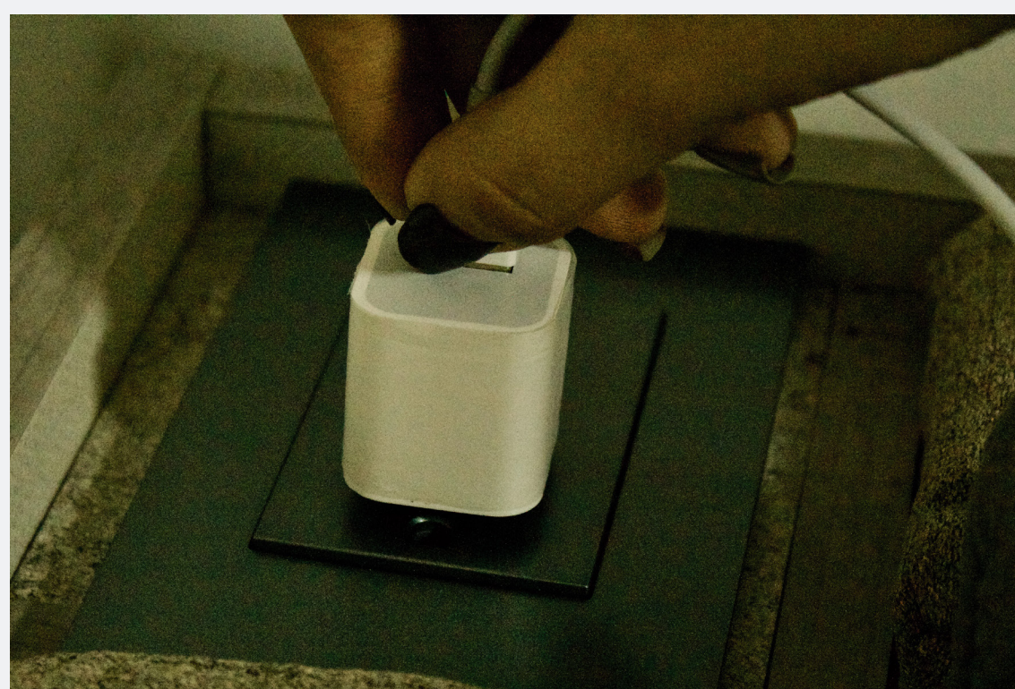
La persona que necesite de una conexión eléctrica puede conectar su dispositivo a la torre de conexión.
