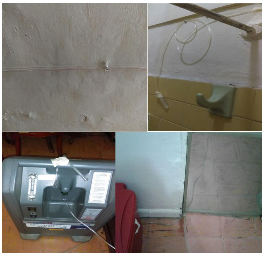
Figura 14. Adecuación extensión de oxígeno
