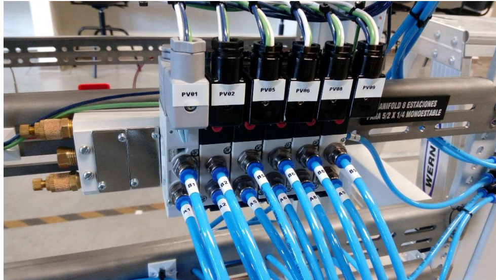
Figura 41. Manifold de 8 estaciones con electroválvulas 5/2
