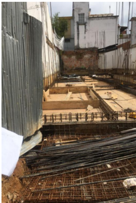
Imagen 2 Fotografía del encofrado para placa y vigas, así como de refuerzos para vigas y columnas.
