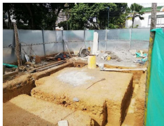
Imagen 6 Construcción no aprobada.
