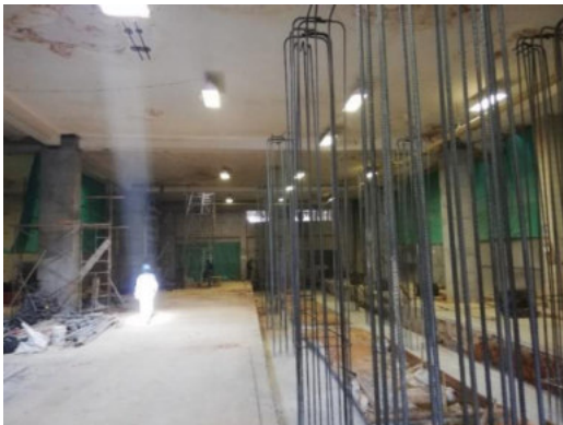
Imagen 32 Construcción de cimientos y columnas para plataforma de concreto para nueva rotativa.
